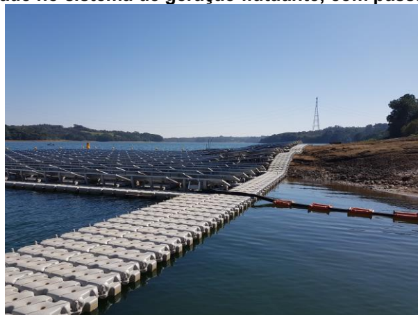
Figura 51 – Adversidade no sistema de geração flutuante, com passarela apoiada em solo.
