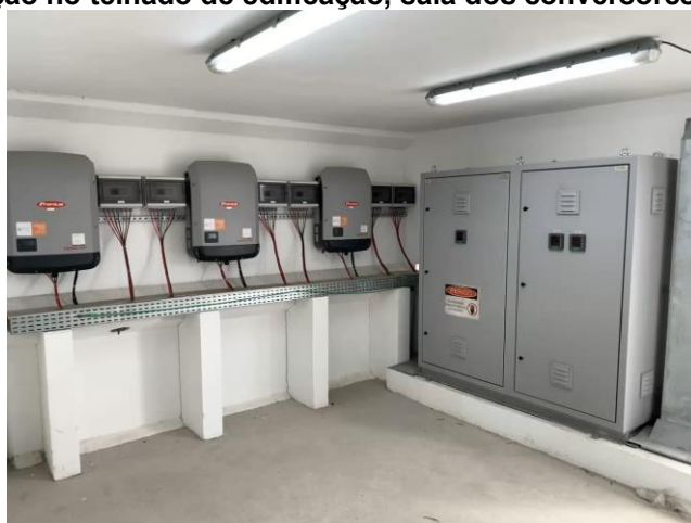
Figura 40 - Instalação no telhado de edificação, sala dos conversores e painéis elétricos.
