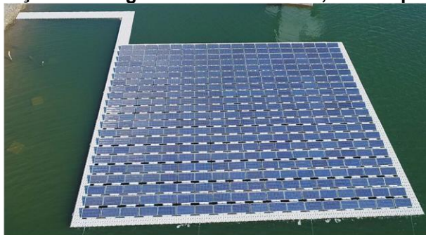
Figura 32 - Sistema de geração de energia flutuante montado, vista específica do sistema.
