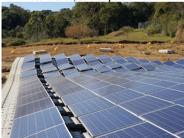
Figura 53 – Adversidade no sistema de geração flutuante, desalinhamento dos módulos fotovoltaico, com o apoio em solo.
