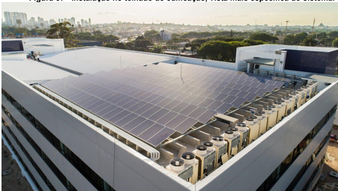
Figura 37 - Instalação no telhado de edificação, vista mais específica do sistema.
