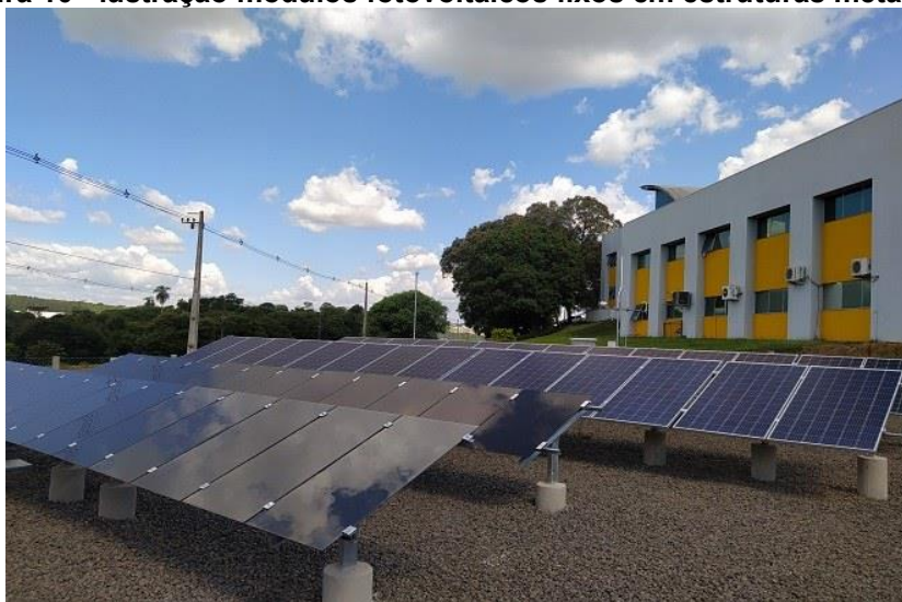
Figura 10 - Ilustração módulos fotovoltaicos fixos em estruturas metálicas.
