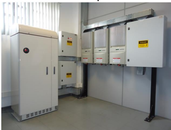
Figura 16 - Inversores do primeiro sistema de geração fotovoltaica homologado e conectado à rede da COPEL – Propriedade ELCO.
