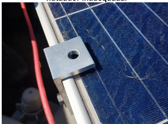
Figura 56 – Adversidade no sistema de geração flutuante, ancoragem dos módulos no flutuador inadequada.
