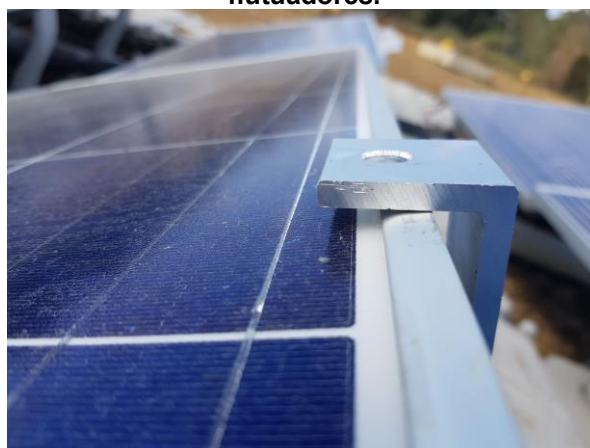
Figura 57 – Adversidade no sistema de geração flutuante, perfil de fixação dos módulos nos flutuadores.
