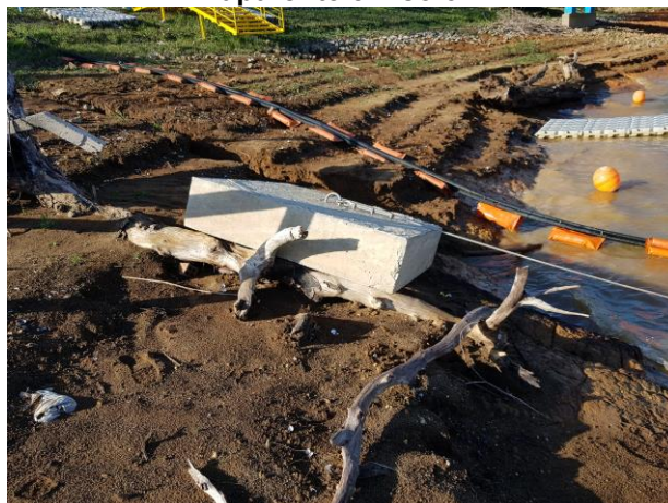
Figura 47 – Adversidade no sistema de geração flutuante, com bloco de ancoragem em aparente em solo.
