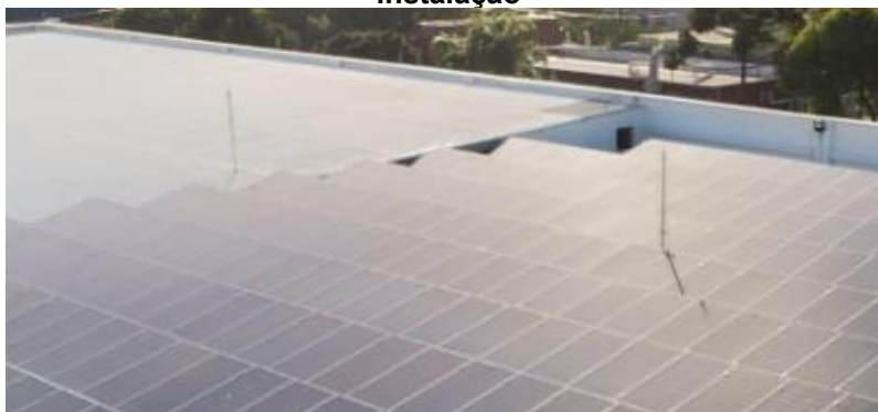
Figura 46 – Adversidades no sistema de geração em telhado com para raio ao meio da instalação
