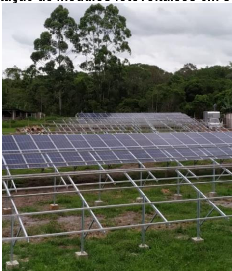
Figura 23 - Estrutura de fixação de módulos fotovoltaicos em solo com estrutura metálica.
