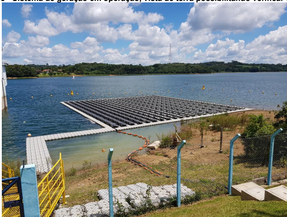
Figura 33 - Sistema de geração em operação, vista de terra possibilitando verificar o acesso.
