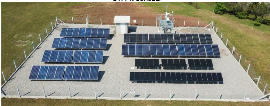
Figura 35 - Estação de geração em solo / EPESOL – Estação de Pesquisa de energia solar UTFPR Curitiba.
