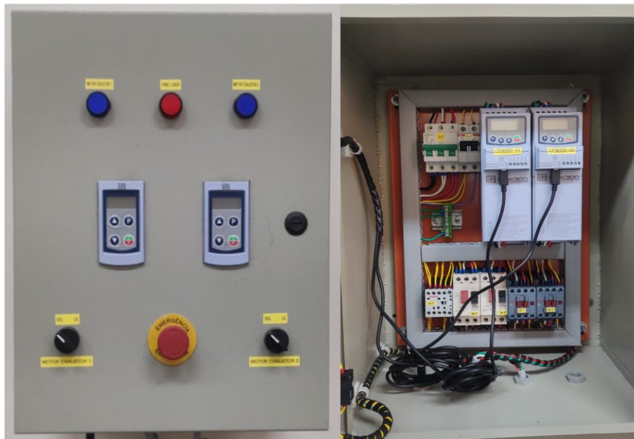
Fotografia 21 – Sistema de controle de rotação do ventilador centrífugo
