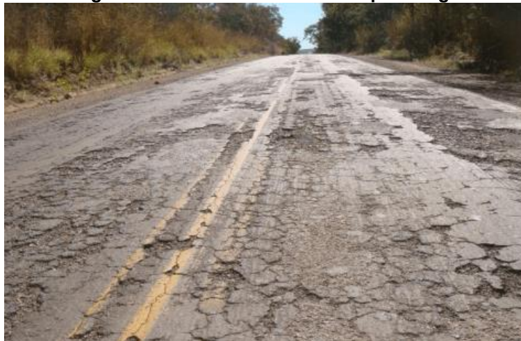
Figura 4 - Pavimento com trincas por fadiga
