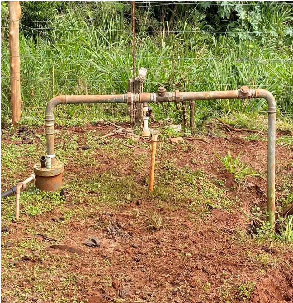
Figura 13 – Vista do sistema de captação de água das comunidades de São Marcos, Takao e Caracol
