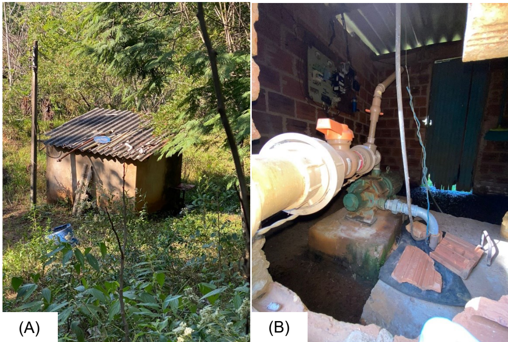
Figura 9 – Sistema de bombas de abastecimento da comunidade de Bragápolis
