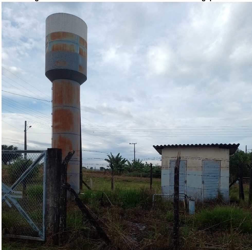
Figura 30 – Vista do reservatório da Vila Rural de Bragápolis
