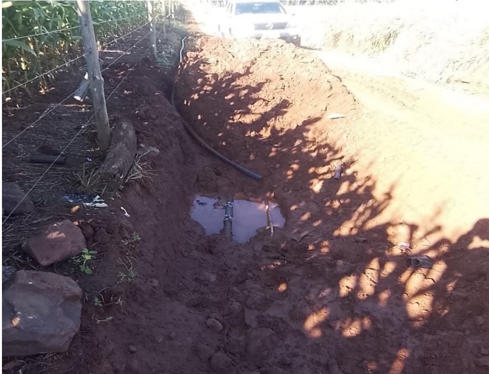
Figura 21 – Obstruções na adutora da SAC da comunidade de São Roque
