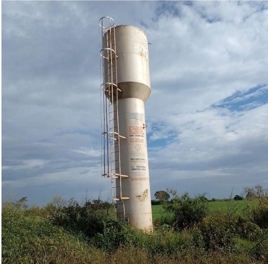
Figura 27 – Sistema de armazenamento de água da comunidade de São Domingos
