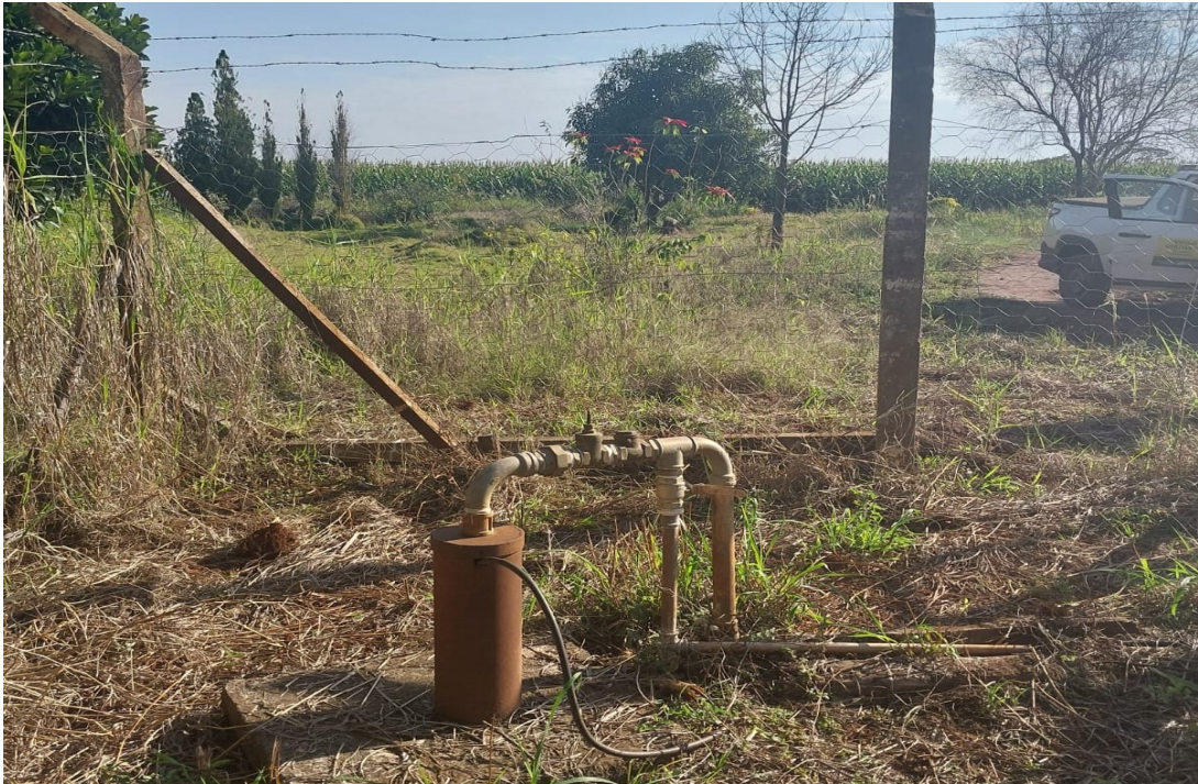
Figura 20 – Vista do ponto de captação de água da comunidade de São Roque
