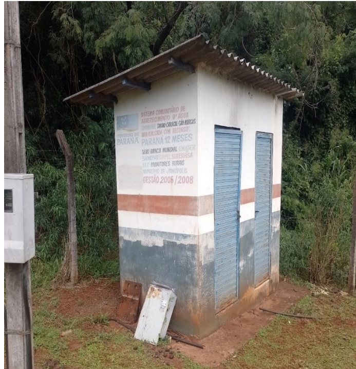
Figura 15 – Casa de bombas da SAC das comunidades de São Marcos, Takao e Caracol
