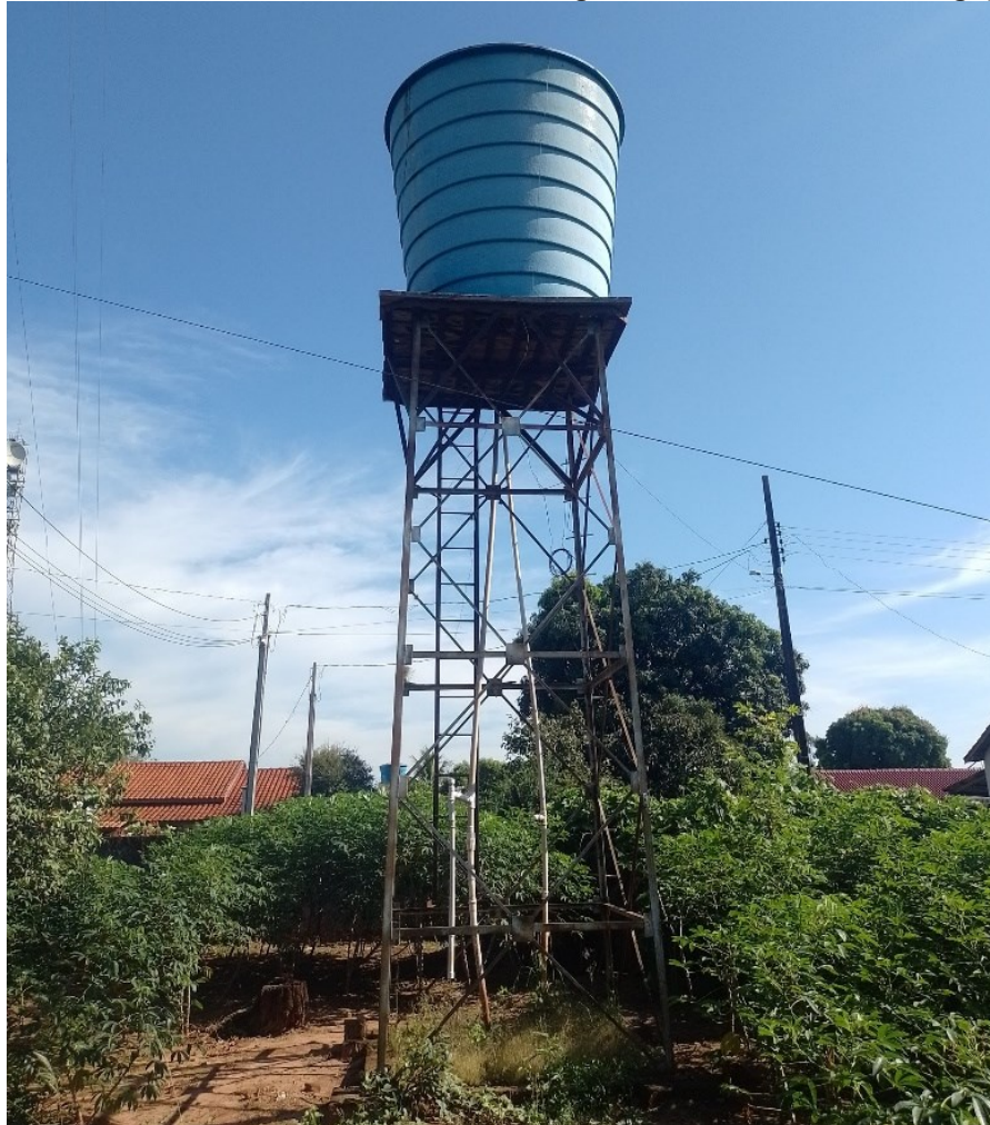
Figura 10 – Sistema de armazenamento de água da comunidade de Bragápolis
