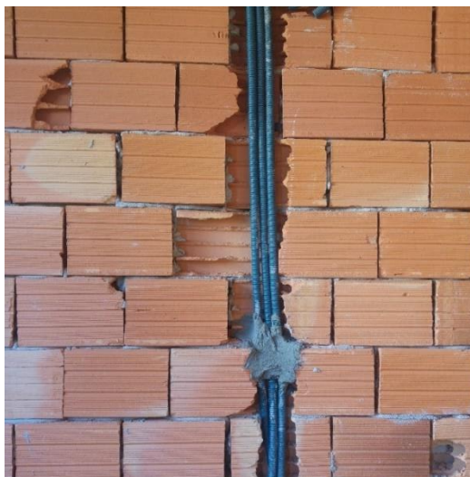
Figura 28 – Eletrodutos embutidos na parede
