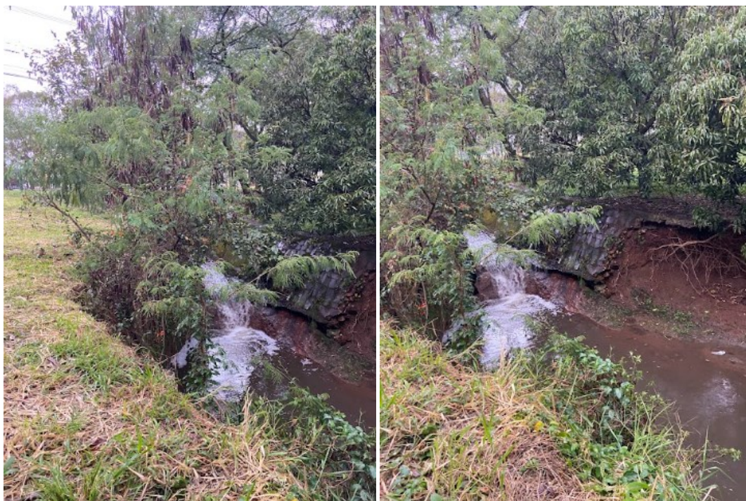
FIGURA 25 – Presença de erosão na sequência da canalização do Córrego Barra Nova
