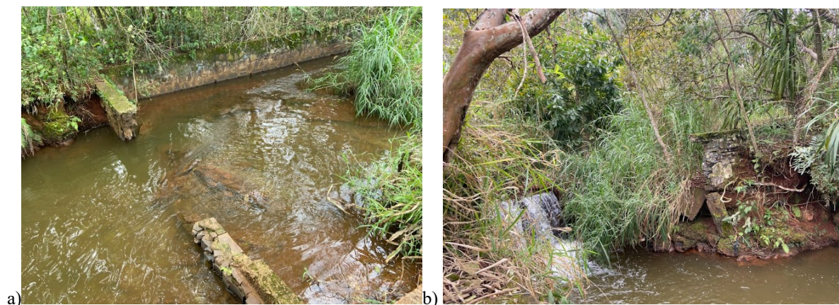
Figura 21 - Registro fotográfico da Seção 2 – Lago Schmidt (Barragem 2) a) Rompimento ocorrido em parte da barragem; b) Processo de erosão e desgaste da estrutura.
