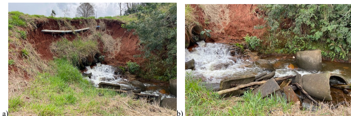
Figura 20 - Registro fotográfico da Seção 2 – Lago Schmidt, a) Processo erosivo observado na continuidade do Córrego Ouro Fino; b) Destaque para os tubos de concreto danificados.
