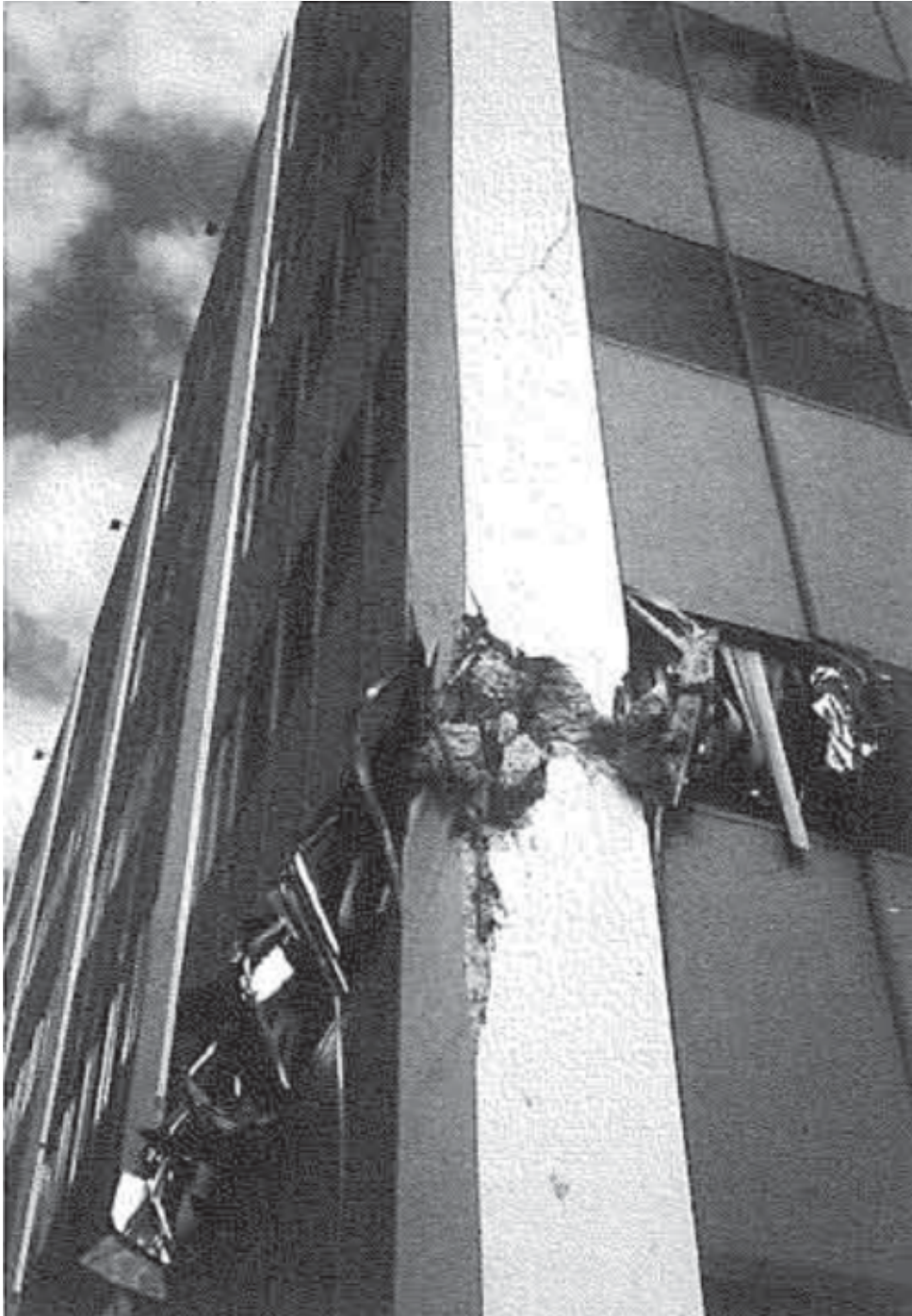
Figura 11 – Danos estruturais em Edifícios causado por vibrações induzida por vento e terremotos leves
