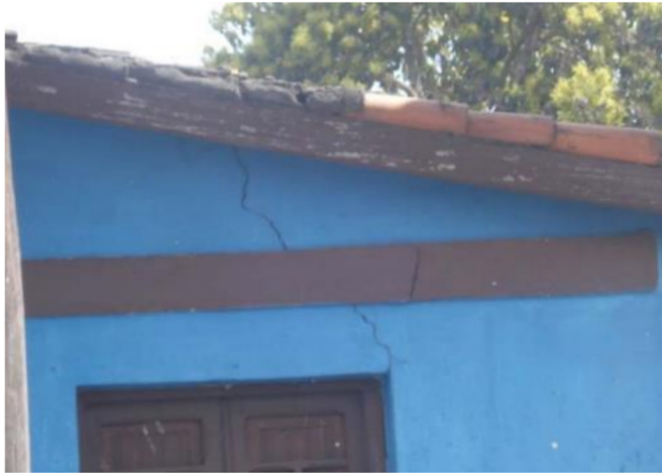
Figura 12 – Trincas causadas pelo efeito de vibração de ferrovias
