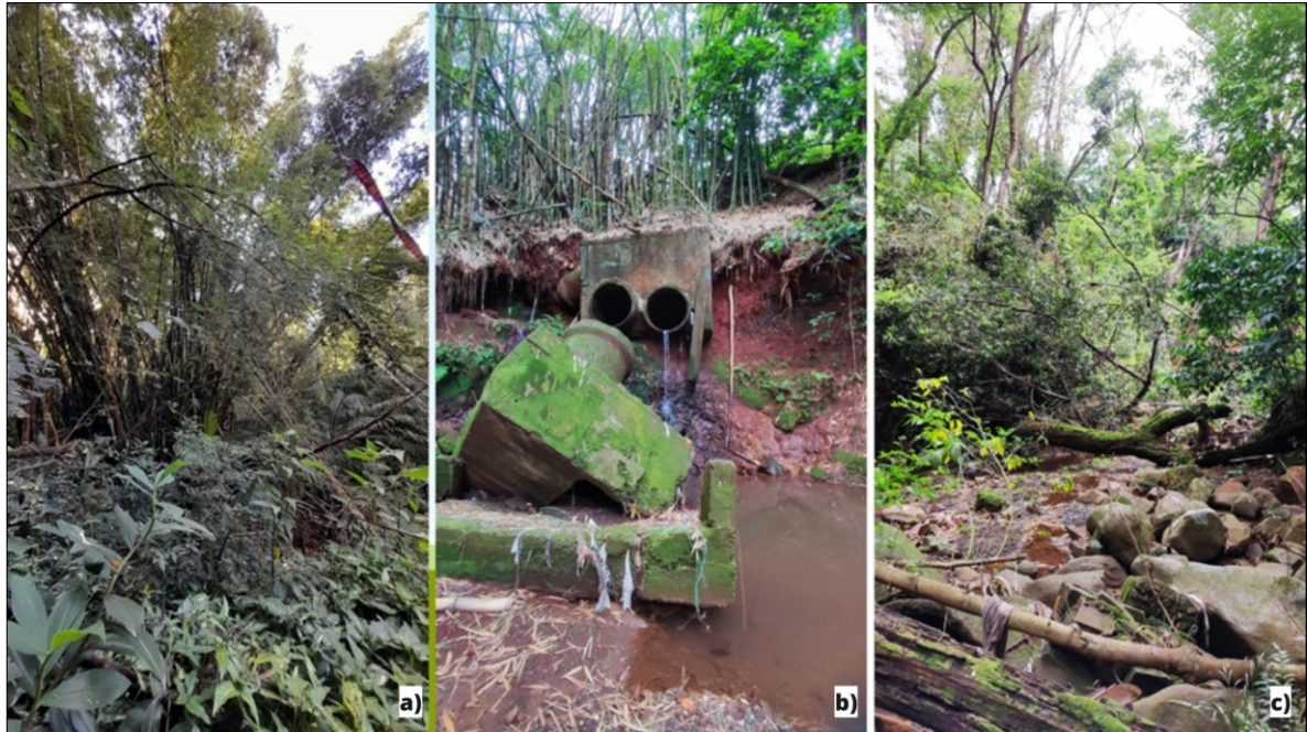
Figura 44 – Ponto D: final da canalização fechada, onde a) área natural ao redor da galeria pluvial; b) erosão acentuada no final da tubulação e coloração acinzentada da água e c) corpo hídrico com diversas barreiras naturais, como cascalhos, árvores caídas e resíduos sólidos.
