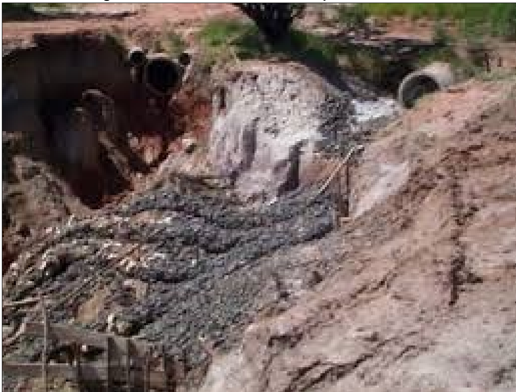
Figura 13 – Erosão urbana no município de Bauru/SP.
