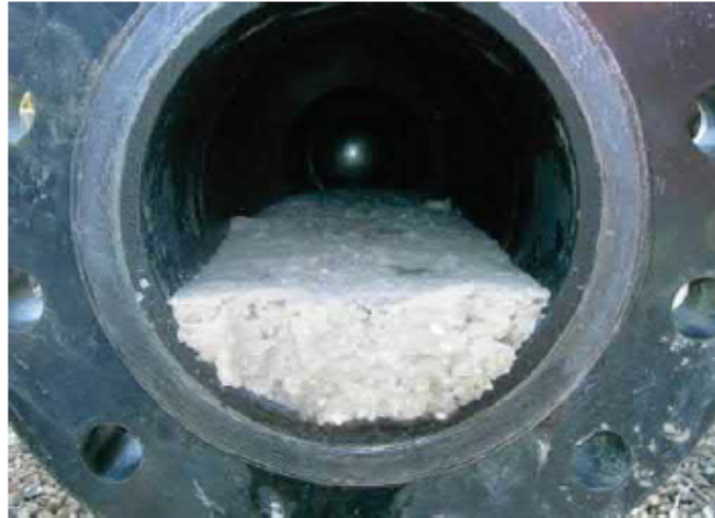
Figura 3 – Interrupção parcial em uma linha de produção devido à formação de hidratos.
