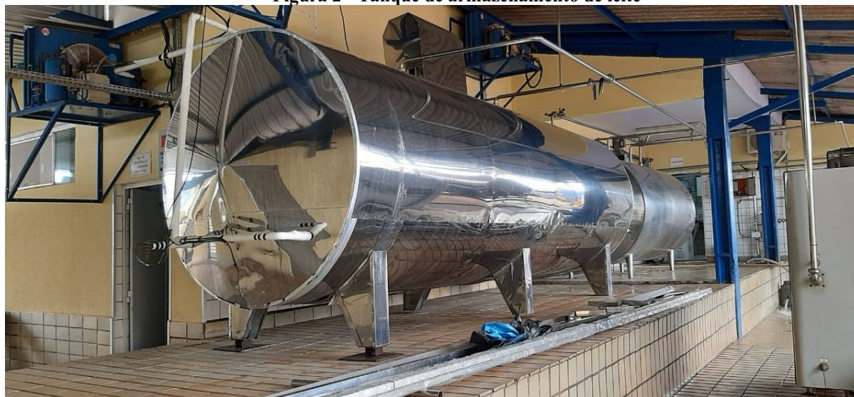
Figura 2 - Tanque de armazenamento de leite
