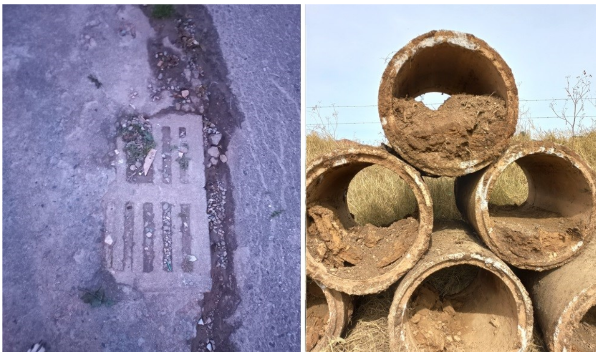
Figura 1 - Impacto do carregamento de solo na drenagem pluvial.
