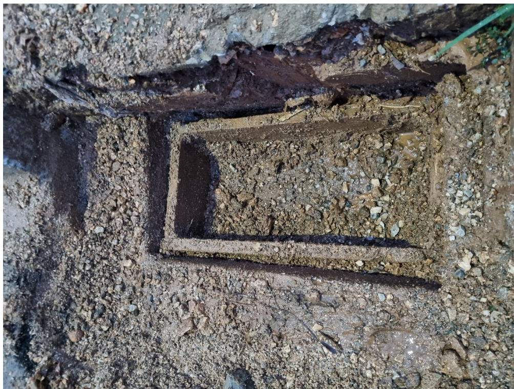
Figura 24 - Caixa instalada em dia chuvoso
