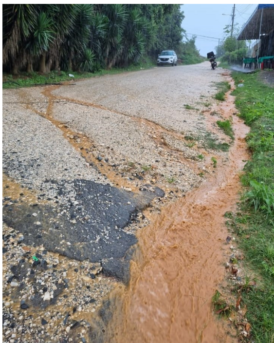
Figura 4 - Estrada com características de erosão por sulcos
