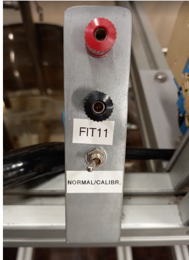
Figura 19: Acesso ao transmissor de vazão (FIT-11)
