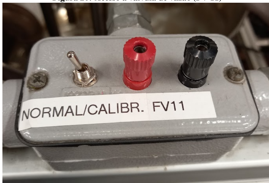
Figura 20: Acesso à valvula de vazão (FV-11)
