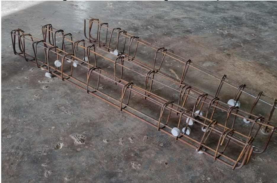
Figura 18 - Armaduras das vigas sem reforço
