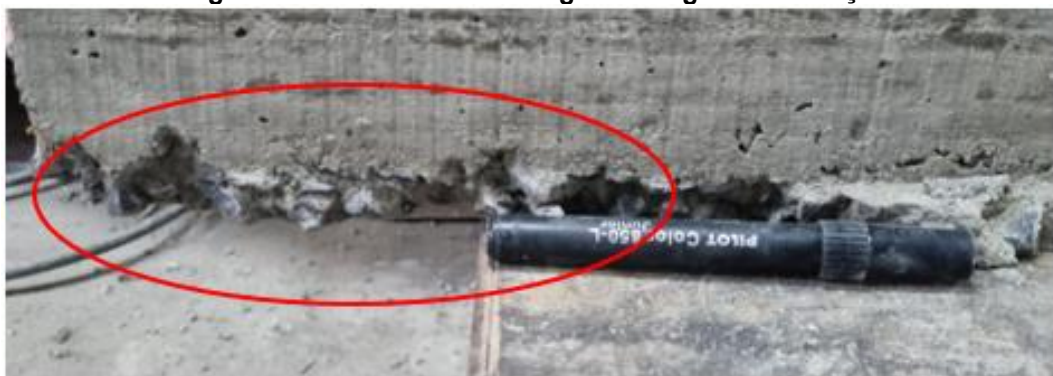
Figura 45 – Falha na concretagem da viga com reforço
