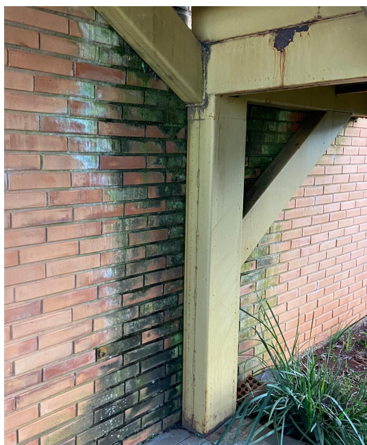
Figura 60 - Manchas externas sala 011
