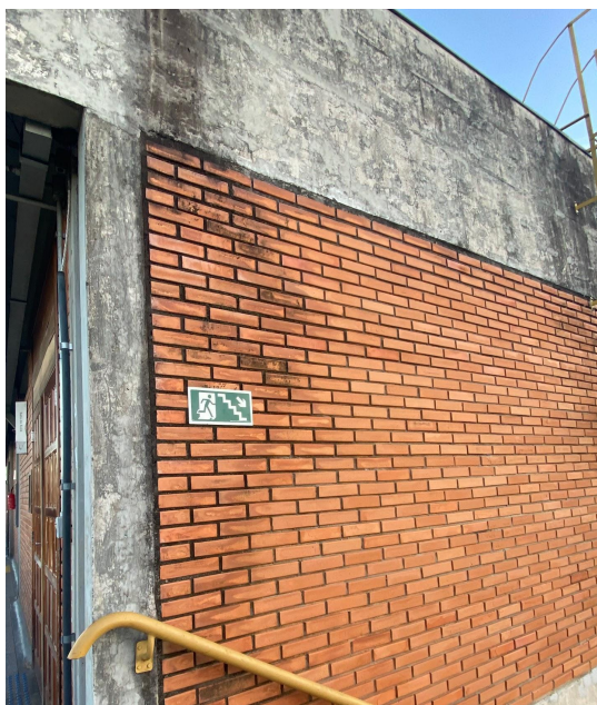
Figura 59 - Manchas externas sala 111
