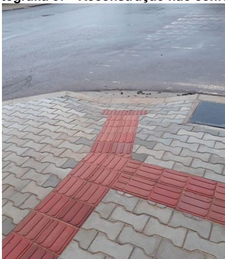
Fotografia 37 - Reconstrução não conforme
