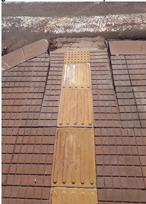
Fotografia 24 - Trecho 3BX: Rampa não conforme
