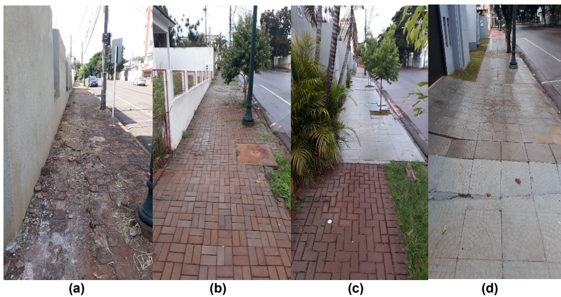
Fotografia 25 - Trecho 3BY: calçamento não conforme
