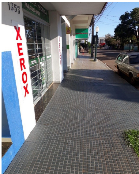
Fotografia 10 - Trecho 2AX: revestimento não conforme
