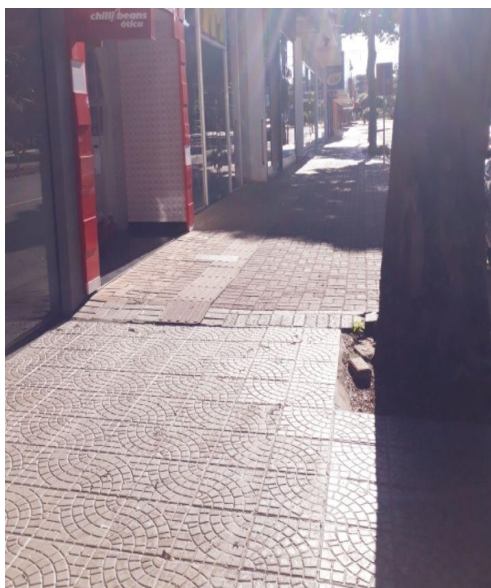
Fotografia 5 - Trecho 1BX: não conformidade
