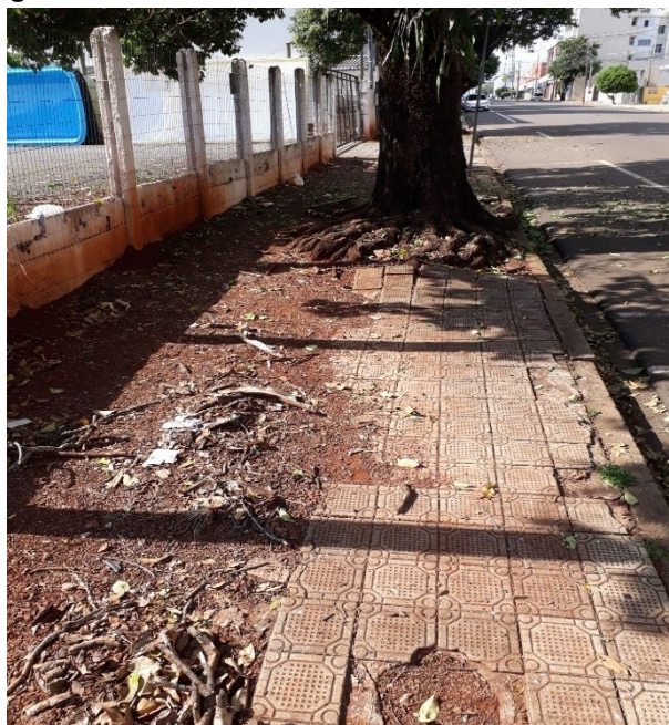
Fotografia 16 - Trecho 2BY: Inexistência de revestimento
