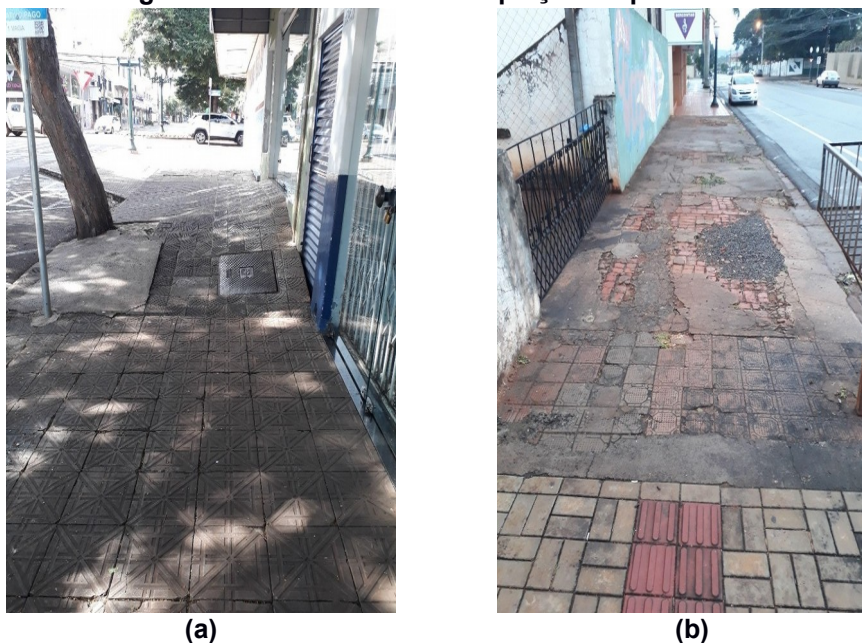
Figura 23 - Trecho 3BX: inadequação no passeio
