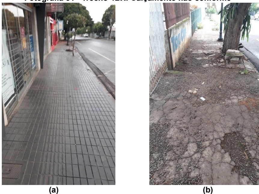
Fotografia 31 - Trecho 4BX: Calçamento não conforme
