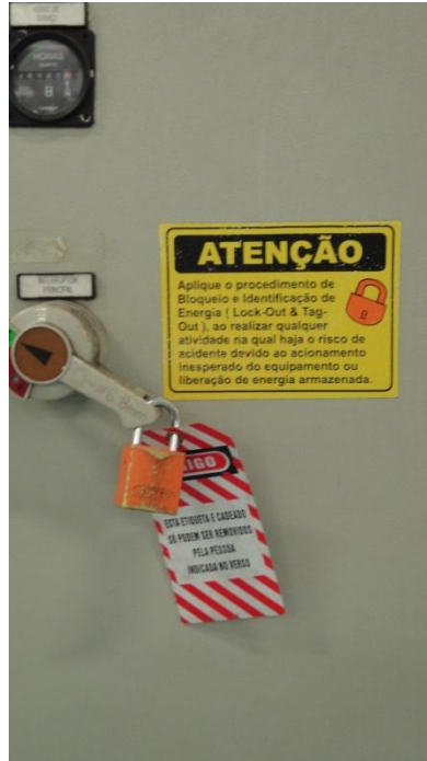
Figura 10: Foto da aplicação de cadeado e etiqueta de identificação para bloqueio de energia em painel elétrico Fonte: Autoria própria (2011)
