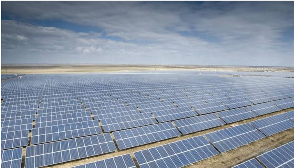
Figura 12 – Usina fotovoltaica localizada na Bahia
