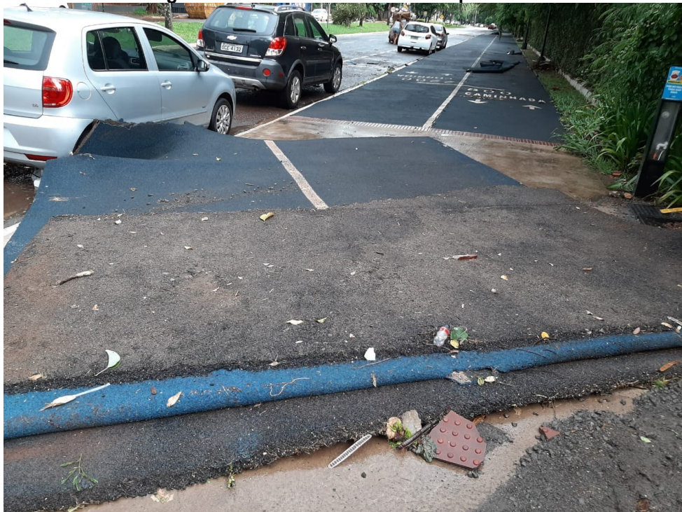
Fotografia 15 - Pista emborrachada após chuvas
