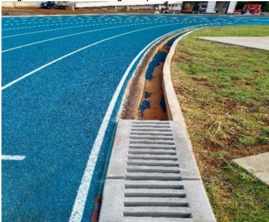
Fotografia 7 - Sistema de drenagem de pista de atletismo em Cascavel-PR
