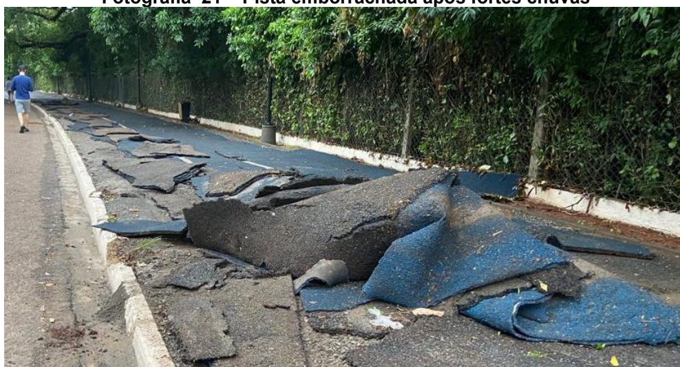
Fotografia 21 – Pista emborrachada após fortes chuvas
