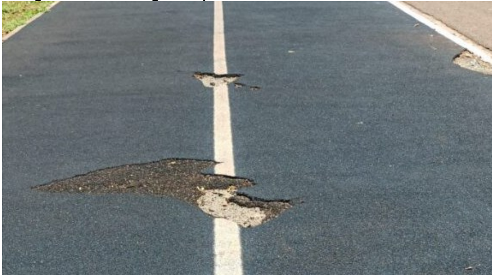
Fotografia 20 – Patologias na pista sintética com menos de um ano de uso
