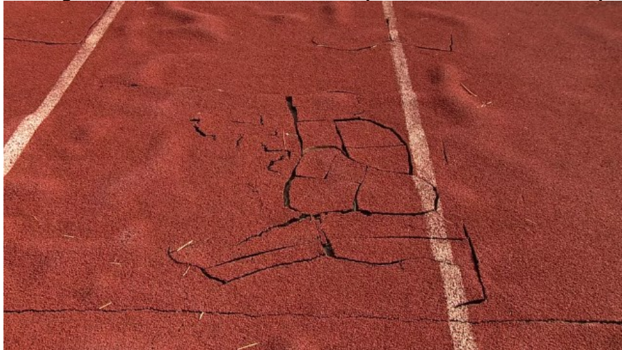
Fotografia 8 - Rachaduras e bolhas na pista de atletismo da Unesp
