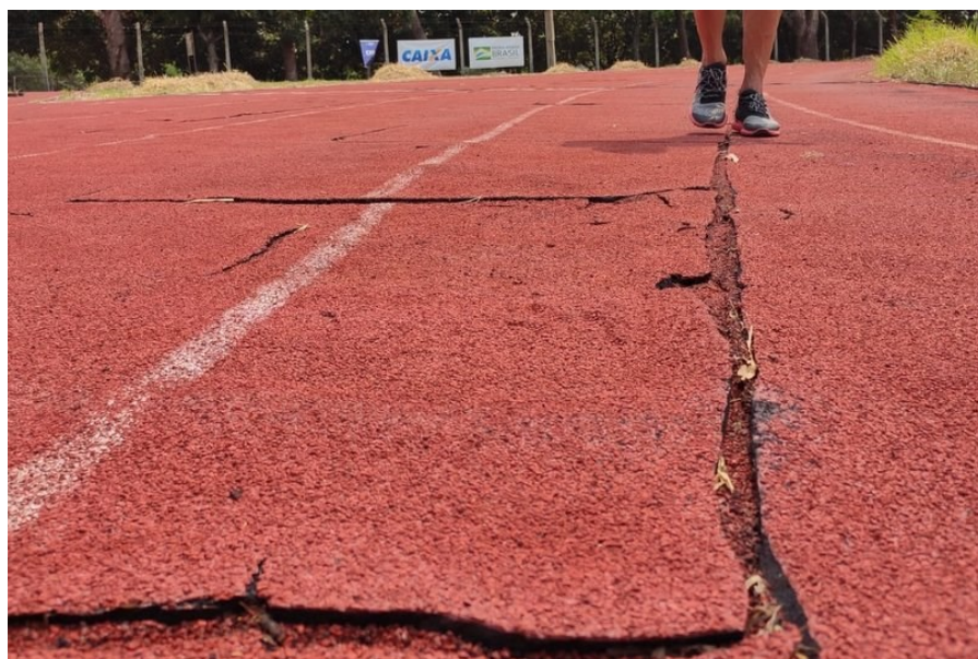
Fotografia 9 - Delaminação da pista de atletismo da Unesp
