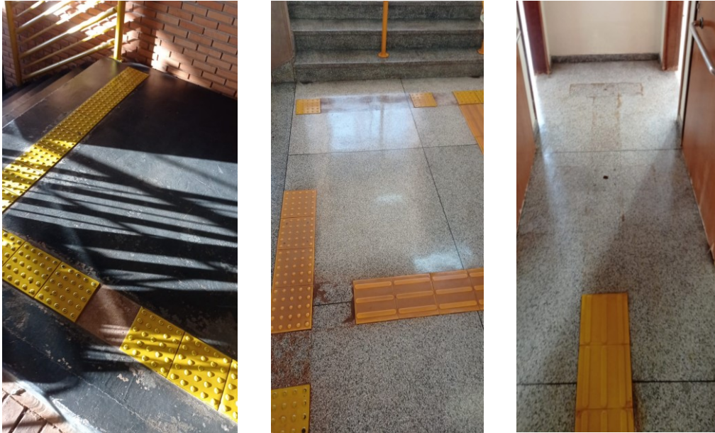
Figuras 12, 13 e 14 – Pisos táteis defeituosos
