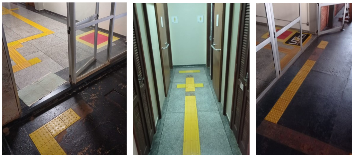
Figuras 42, 43 e 44 – Pisos táteis defeituosos
