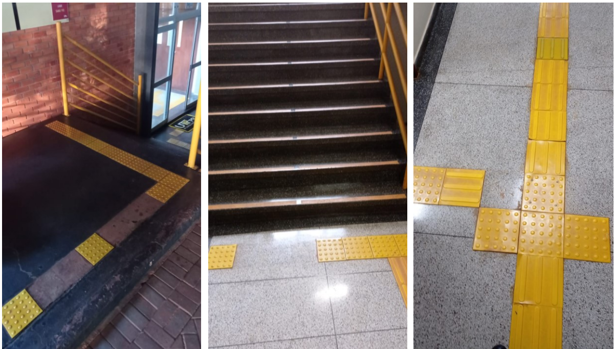
Figuras 18, 19 e 20 – Pisos táteis defeituosos
