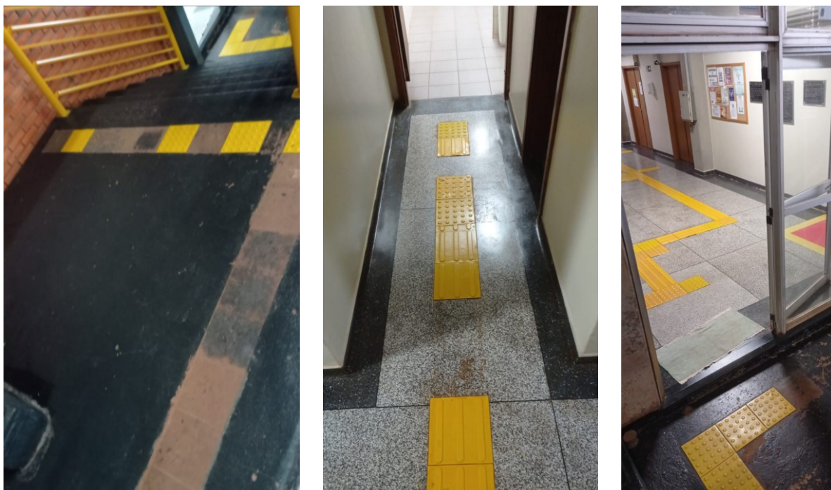
Figuras 32, 33 e 34 – Pisos táteis defeituosos
