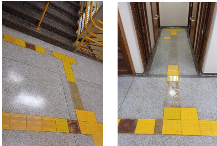
Figuras 37 e 38 – Pisos táteis defeituosos
