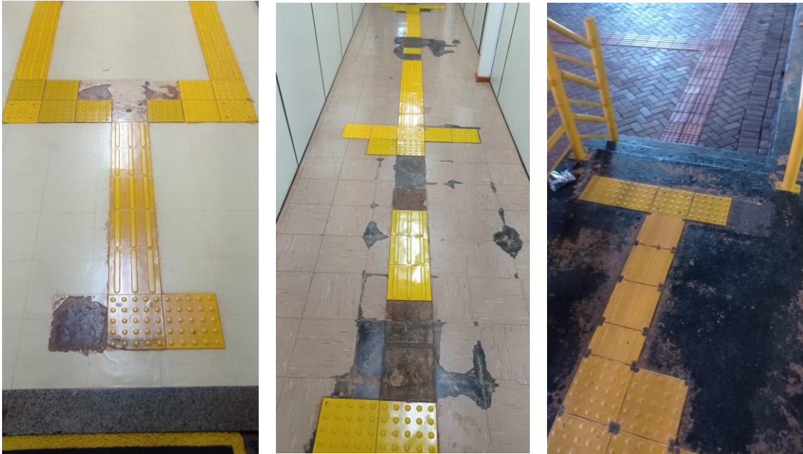
Figuras 7, 8 e 9 – Pisos táteis defeituosos
