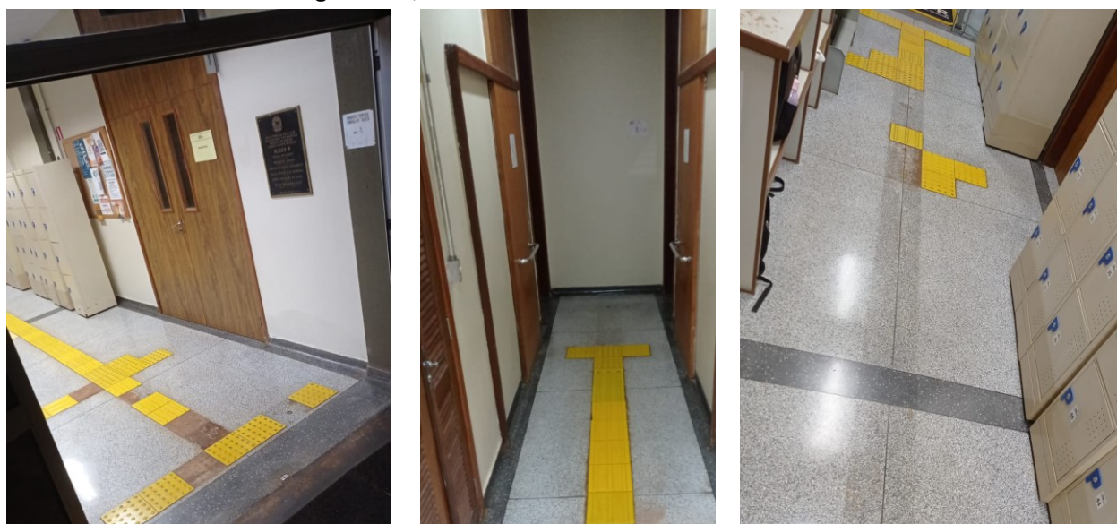
Figuras 23, 24 e 25 – Pisos táteis defeituosos
