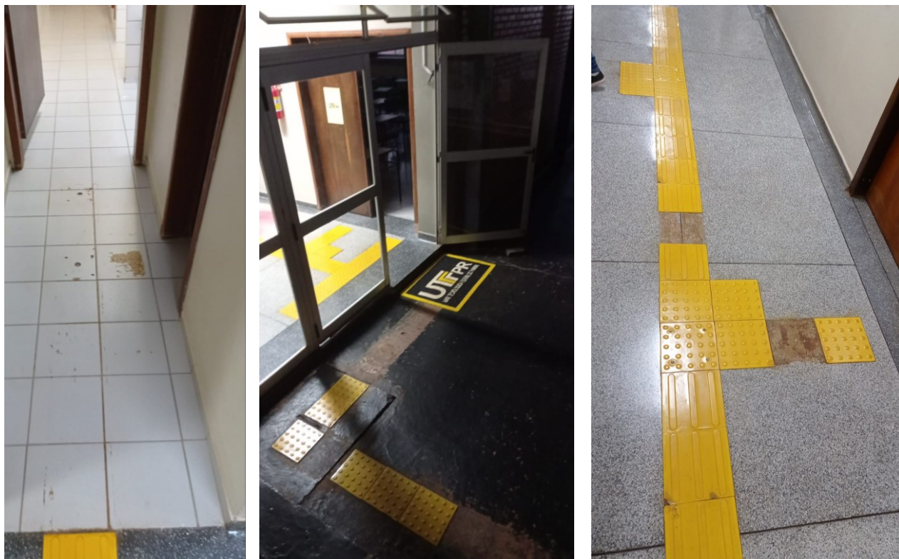
Figuras 27, 28 e 29 – Pisos táteis defeituosos
