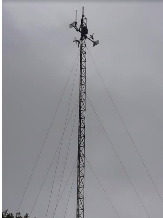
Fotografia 1 - Torre de distribuição de internet
