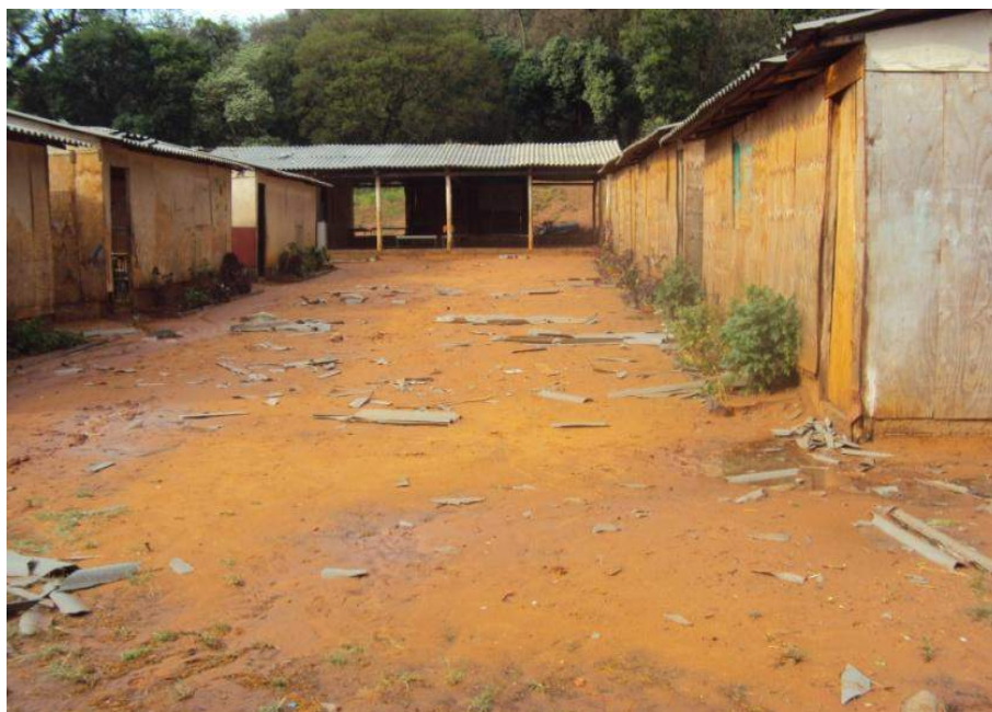
Figura 38: Fotografia externa da Escola Itinerante Valmir Motta de Oliveira parcialmente destruída após temporal, em 2011.
