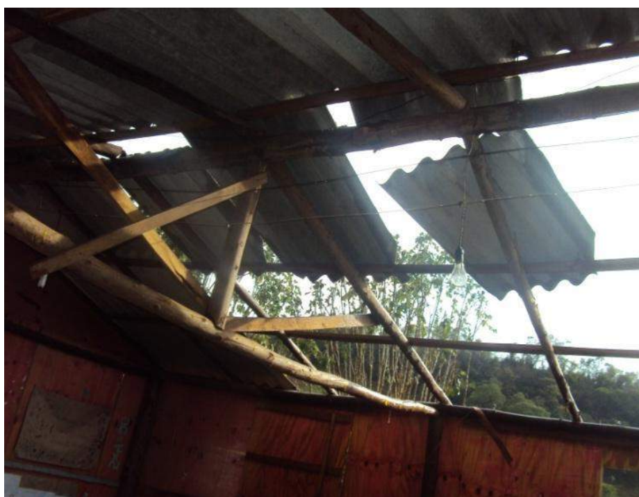
Figura 39: Fotografia do telhado da Escola Itinerante Valmir Motta de Oliveira, que foi parcialmente destruída após temporal, em 2011.
