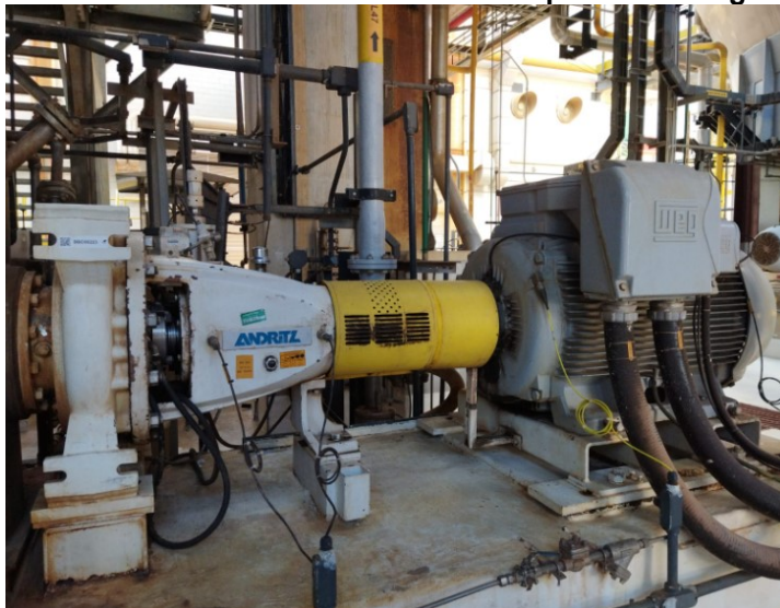
Figura 16 – Bomba de média consistência do primeiro estágio dióxido
