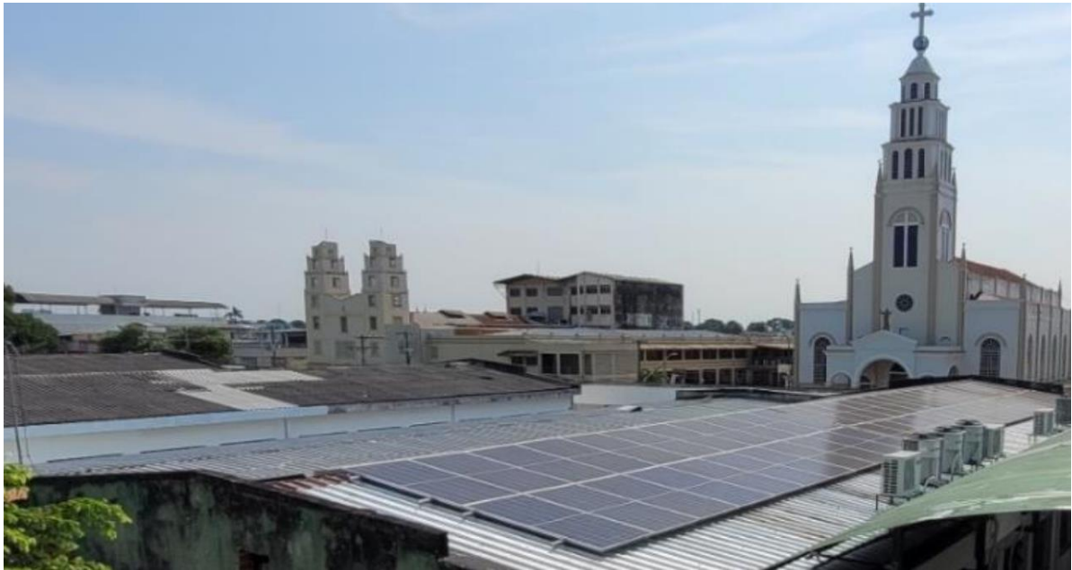
Figura 16 - Vista panorâmica do SFVCR, lado Sul.
