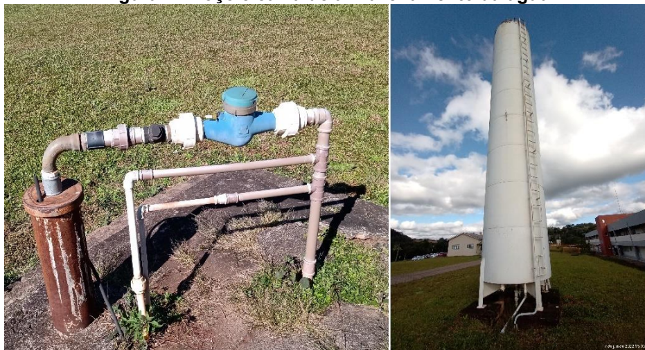
Figura 7 - Poço e caixa de armazenamento da água.
