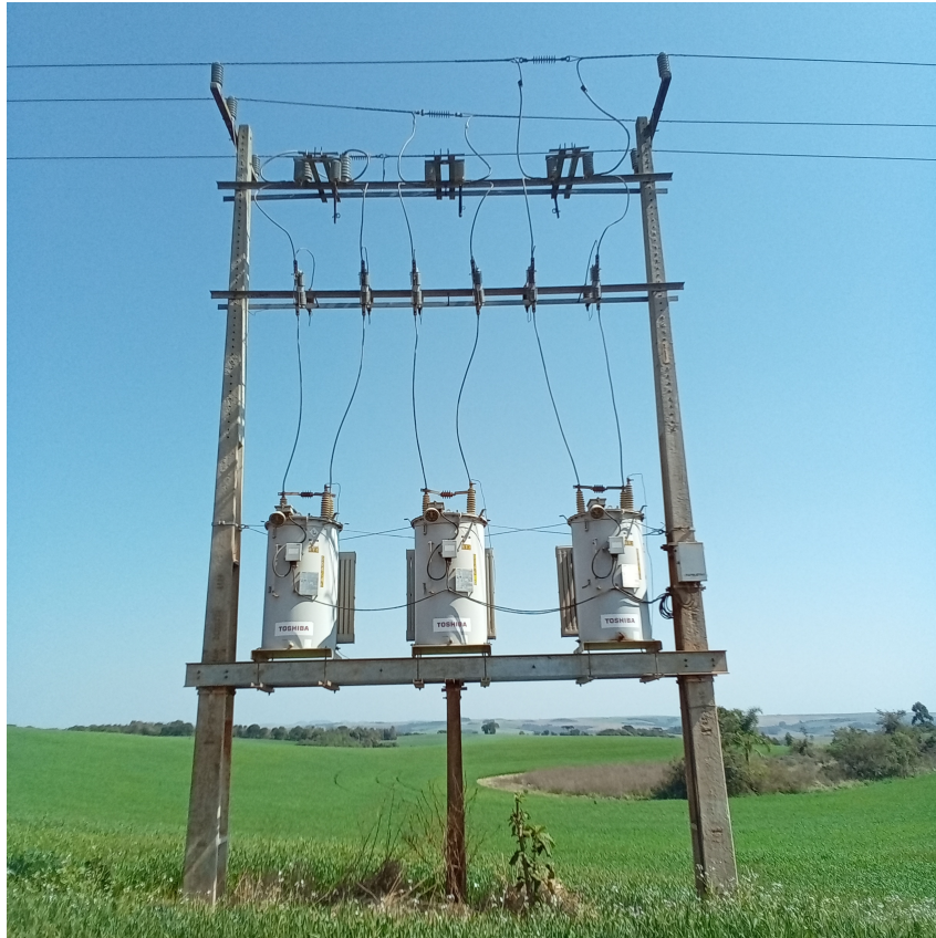
Figura 22 – Banco regulador de tensão
