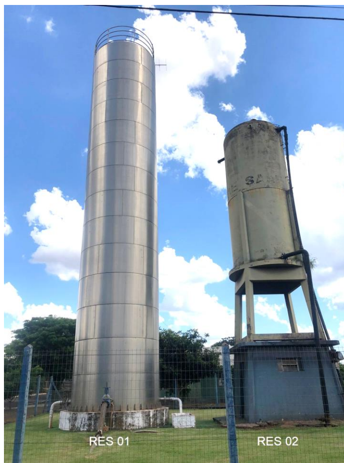
Figura 9 - Reservatórios do SQPA.
