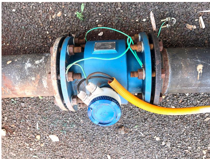
Figura 12 - Hidrômetro Horizontal para Realização da Macromedição do SQPA
