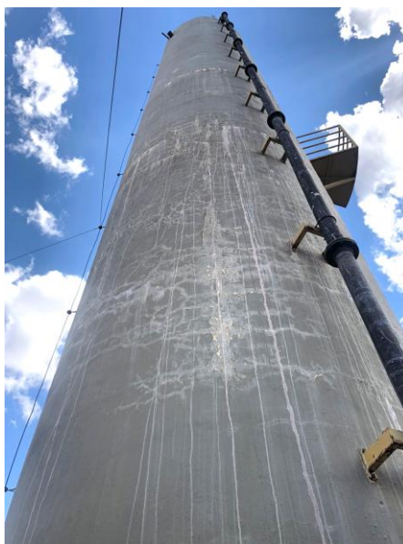
Figura 13 - Lixiviação em Reservatório de Concreto
