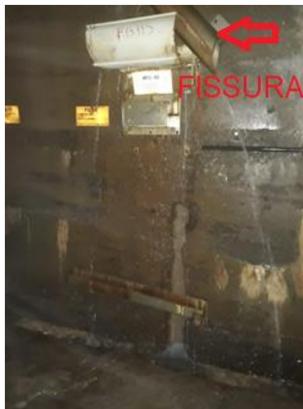
Figura 23 - Água vertendo pela fissura dentro da galeria da Barragem
