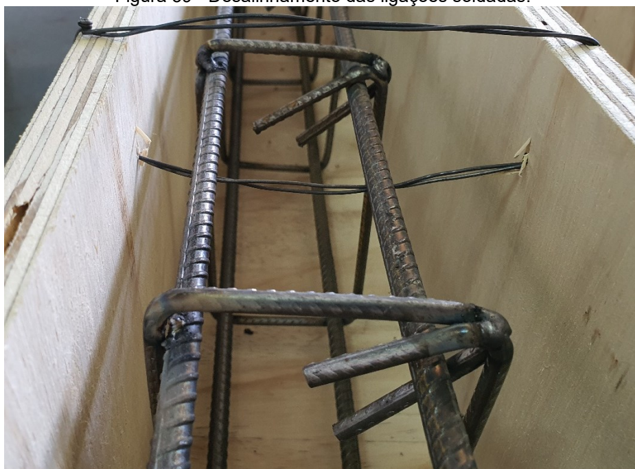
Figura 39 - Desalinhamento das ligações soldadas.
