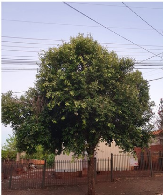
Figura 8 – Problemas com a fiação elétrica da Licania tomentosa no Bairro Jardim Gramado.
