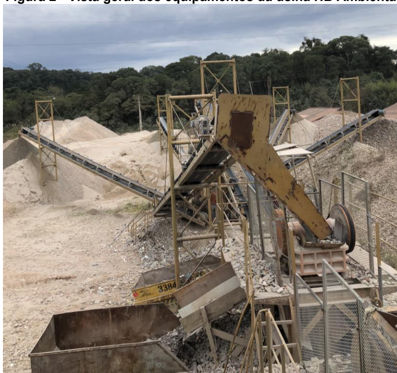
Figura 2 - Vista geral dos equipamentos da usina HB Ambiental
