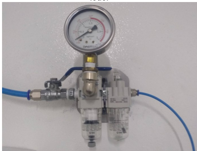
Fotografia 3. Manômetro utilizado para aeração do lodo.
