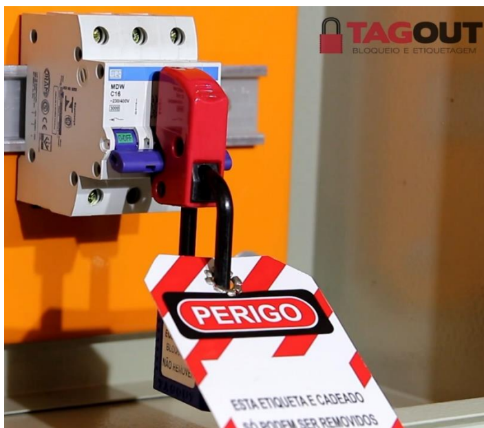
Figura 12: Dispositivo de proteção bloqueado e sinalizado conforme NR-10 Fonte: TAGOUT Bloqueio e Etiquetagem (2019)
