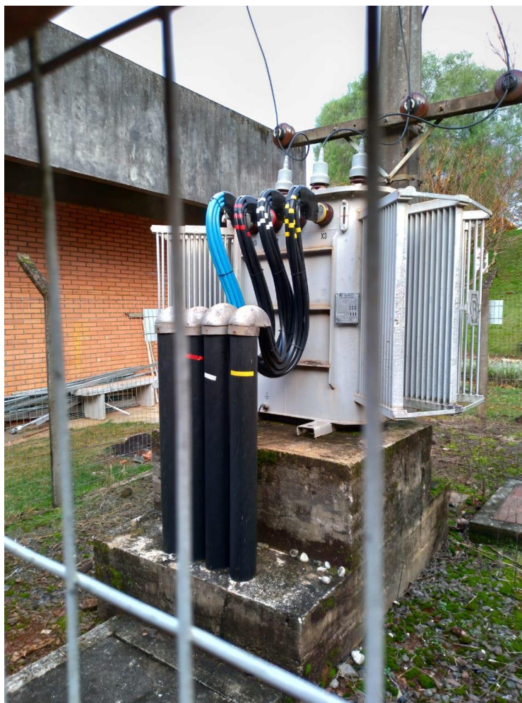
Figura 4: Transformador 1 de 500kVA e 13200/220-127V Fonte: Autoria própria (2019)
