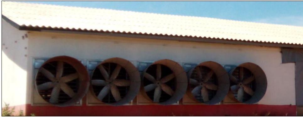
Figura 10 - Vista externa do conjunto de exaustores. Fonte: Autoria própria.
