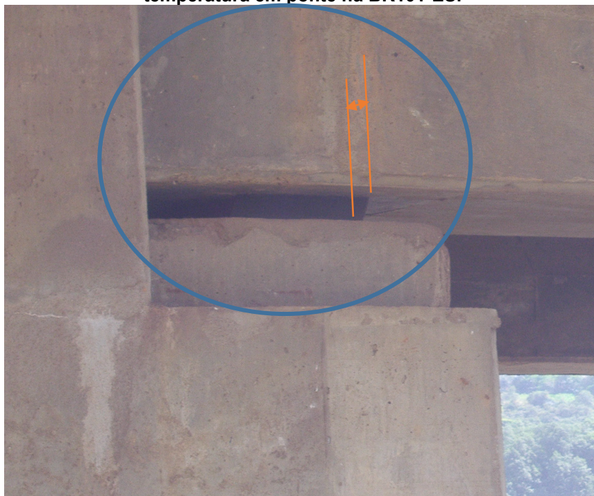
Figura 12 - Detalhe de aparelho de apoio de neoprene fretado com distorção por efeito da temperatura em ponte na BR101-ES.
