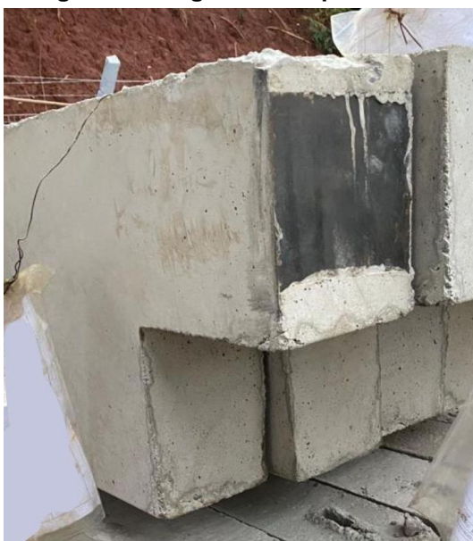
Figura 27 – Viga com chapa metálica
