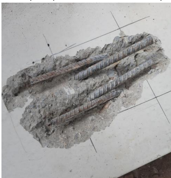
Figura 30 – Esperas para consolo fora do local especificado
