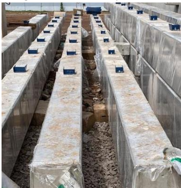
Figura 26 – Pilar com chapas metálicas
