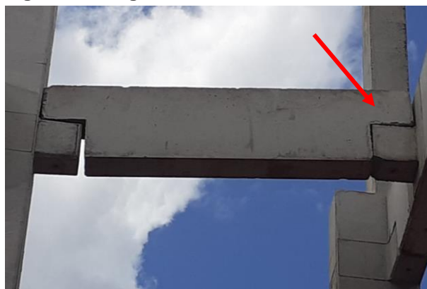
Figura 21 – Viga com consolo na medida errada
