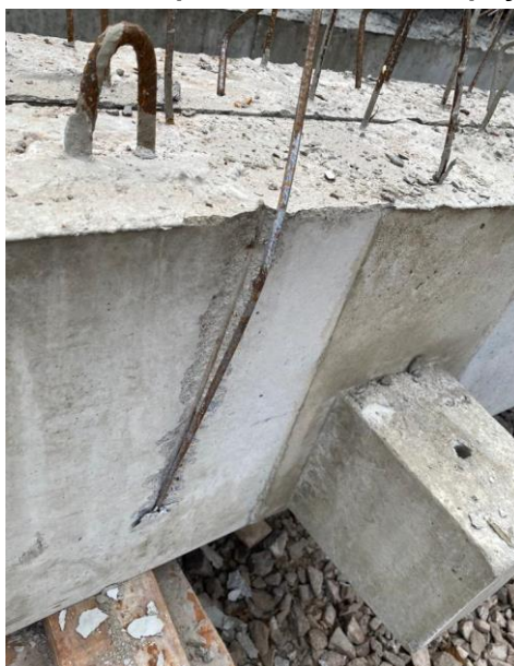
Figura 20 – Consequência da falta de espaçadores
