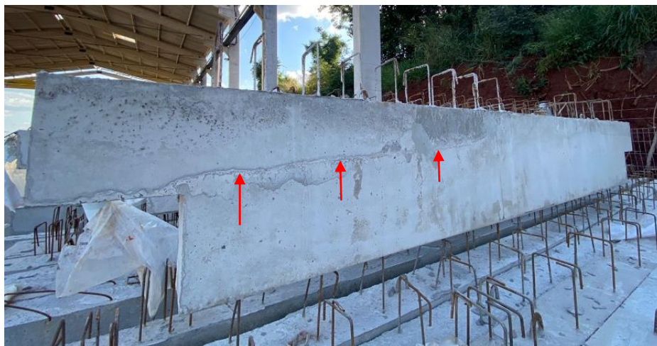
Figura 25 – Viga com junta fria
