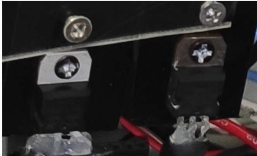
Figura 18 – C.I's reguladores de tensão.
