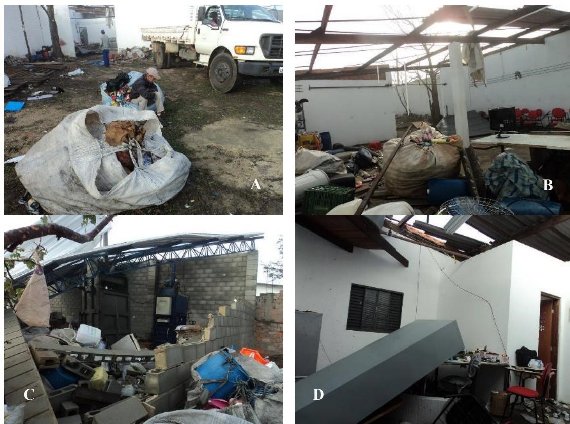
Figura 16 – Sede da Cooperativa recém-inaugurada após intenso temporal, ano de 2013. A – Chegada dos cooperados ao local no dia seguinte ao temporal. B – Galpão destelhado. C – Paredes atingidas. D – Escritório danificado.
