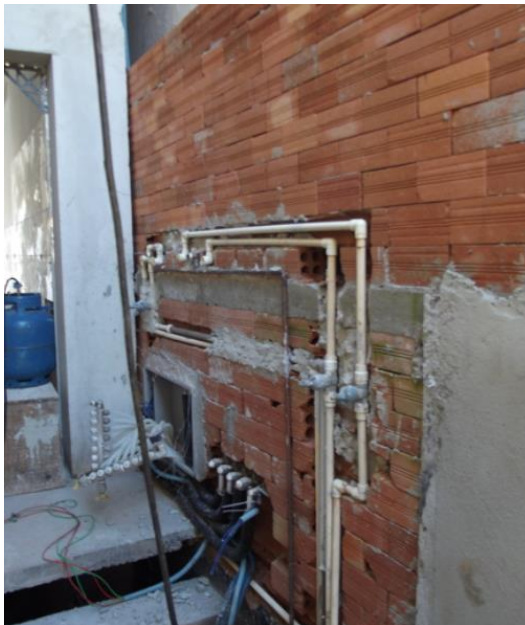
Figura 32: Instalações elétricas e hidrossanitárias no sistema convencional Fonte: AC Construtora, 2021.
