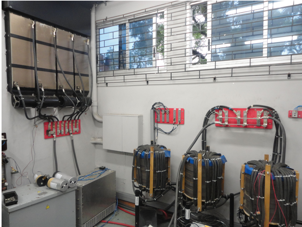
Figura 60 – Ambiente de testes - indutor e resistores de carga.
