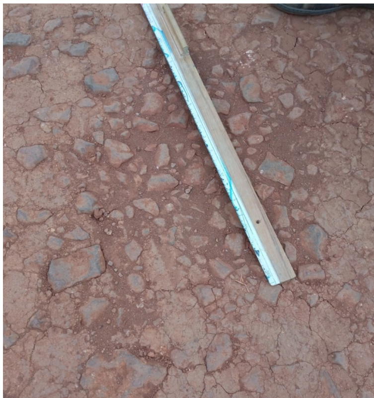
Figura 85: buraco Fonte: autoria própria (2021).
