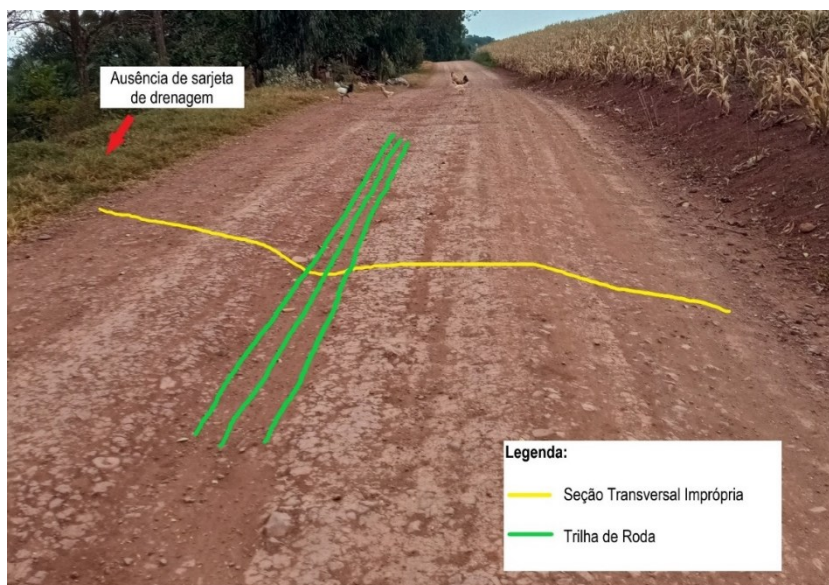
Figura 86: observação das patologias na Unidade Simples PBE03/02/02 Fonte: autoria própria (2021).
