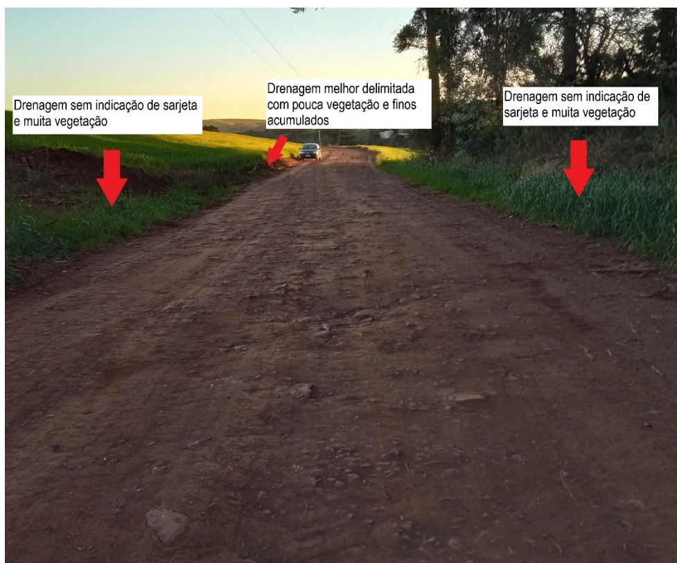
Figura 58: observação das patologias na Unidade Simples PBE01/01/01 Fonte: autoria própria (2021).
