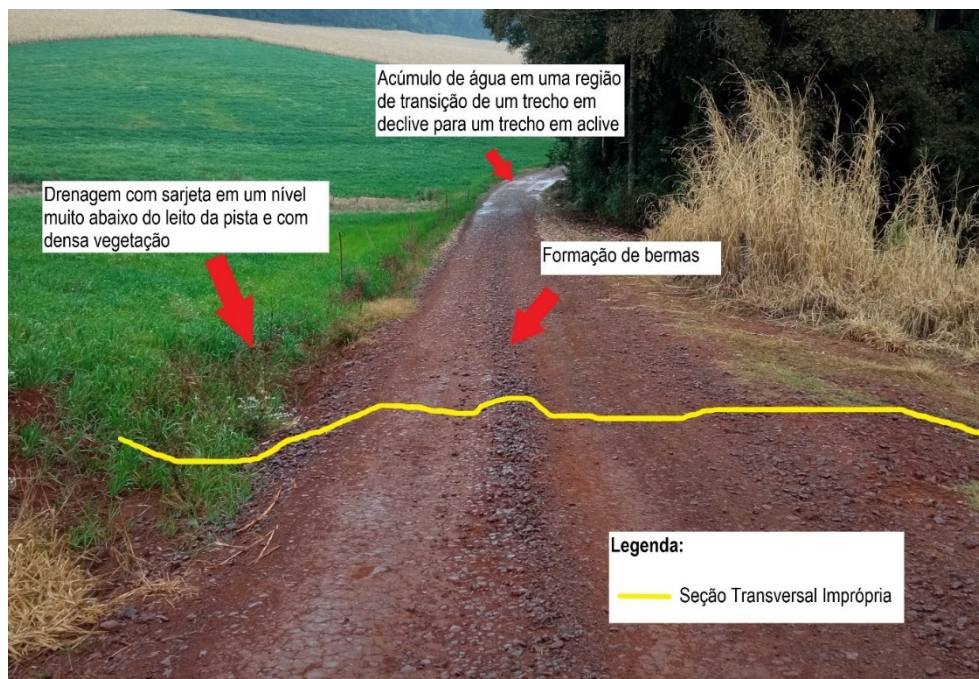
Figura 82: observação das patologias na Unidade Simples PBE03/01/03 Fonte: autoria própria (2021).
