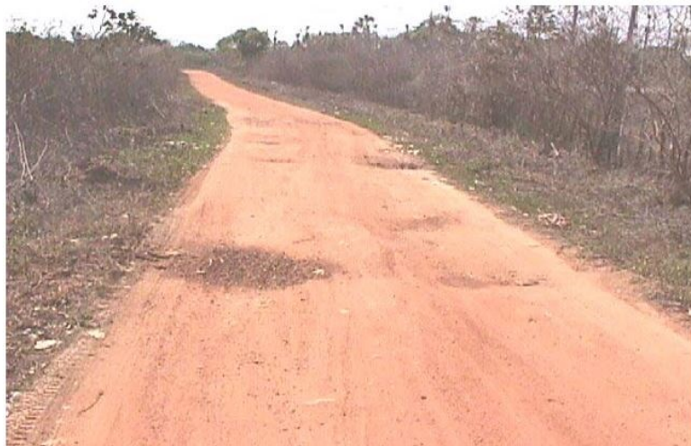
Figura 20: buracos ou panelas Fonte: Moreira (2003).
