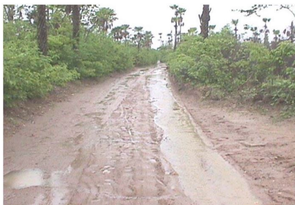
Figura 8: greide "encaixado" - seção transversal inadequada Fonte: Moreira (2003).
