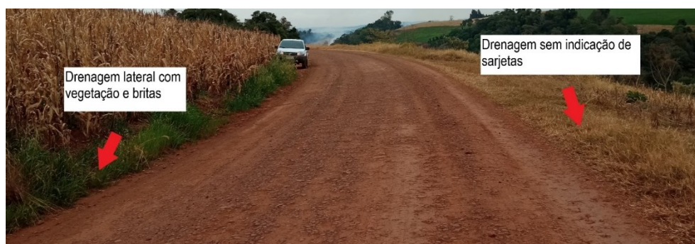
Figura 84: observação das patologias na Unidade Simples PBE03/02/01 Fonte: autoria própria (2021).
