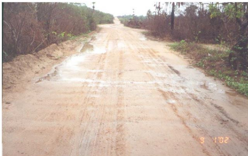
Figura 34: drenagem lateral inadequada Fonte: Moreira (2003).
