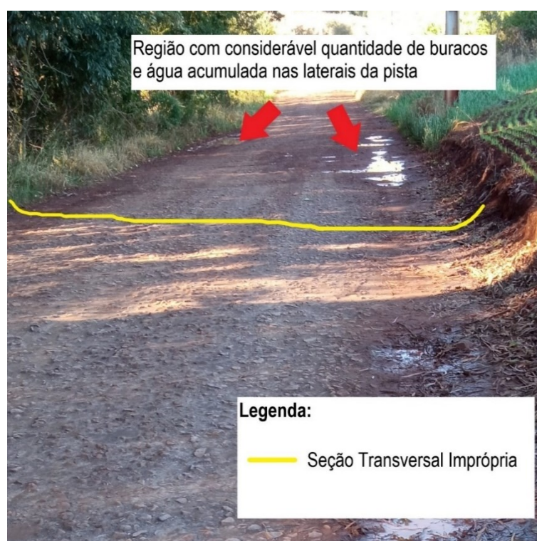
Figura 74: observação das patologias na Unidade Simples PBE02/02/01 Fonte: autoria própria (2021).
