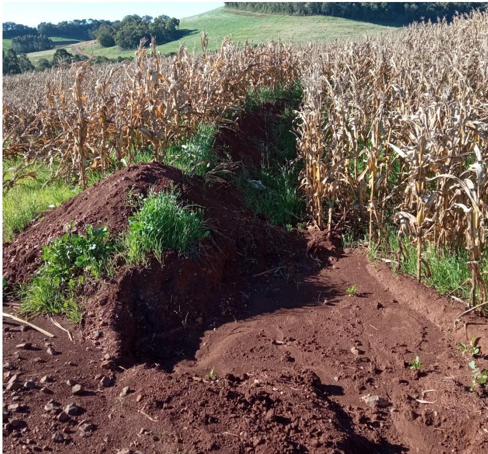
Figura 79: indicação de sangra/bigode para escoar a água da sarjeta para fora da plataforma Fonte: autoria própria (2021).
