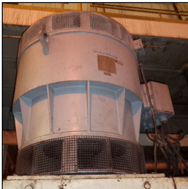
Figura 29 - Motor da Centrífuga Automática Fonte: Raízen (2015)
