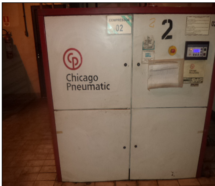
Figura 7 - Compressor de ar
