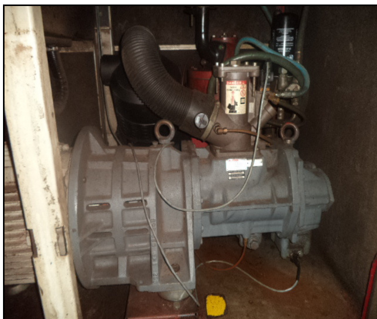
Figura 9 - Unidade geradora de ar do compressor de parafuso duplo Fonte: Raízen (2015)
