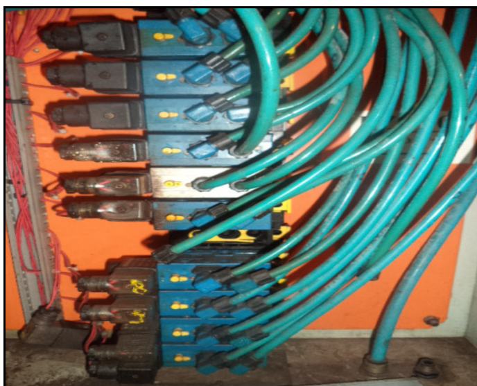
Figura 24 - Comando de Válvulas Direcionais em Bloco Fonte: Raízen (2015)
