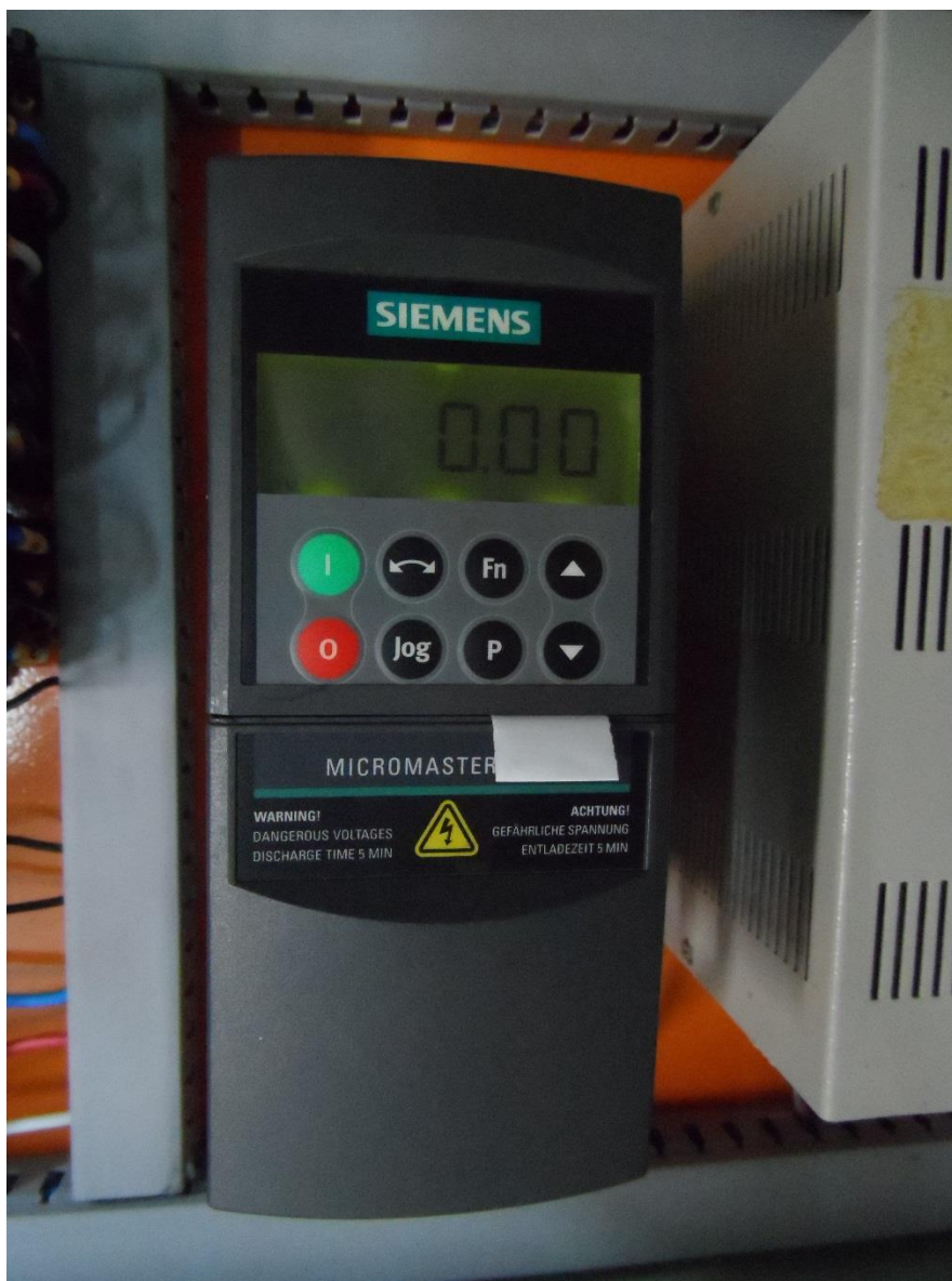
Figura 24 - Inversor de Frequência Siemens Micromaster 420 Fonte: Autoria própria
