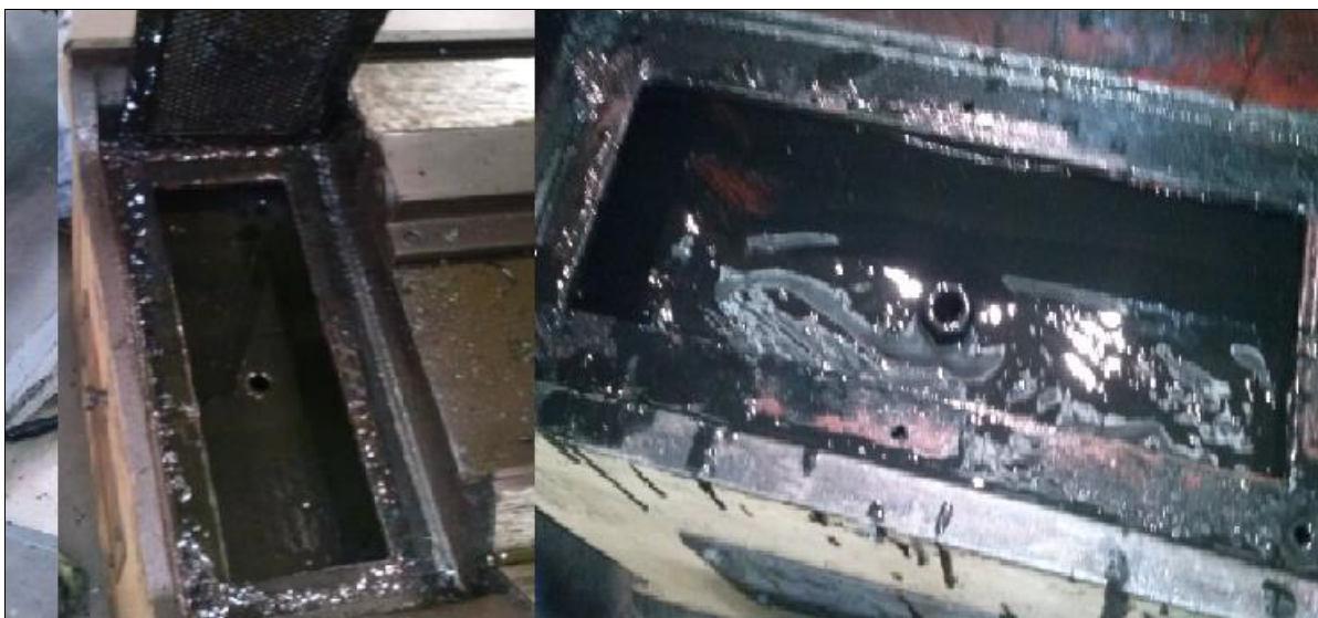
Figura 13: Compartimento de decantação de óleo para barramentos contaminado
