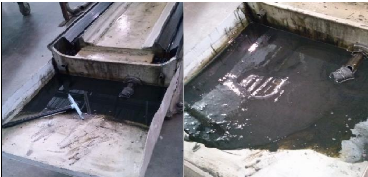
Figura 12: Compartimento de filtragem 1 (malha grossa) de óleo para barramentos exposta ao meio
