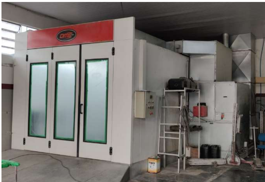
Figura 31 - Cabine de Pintura Visita Técnica
