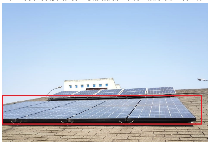
Figura 22: Módulos Solares instalados no telhado do Escritório Verde.
