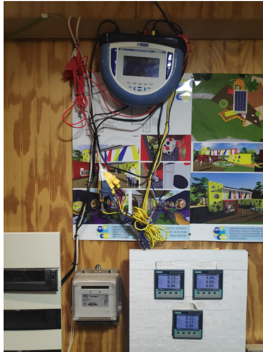
Figura 31: Analisador RE6000 conectado ao SFVCR do EV.
