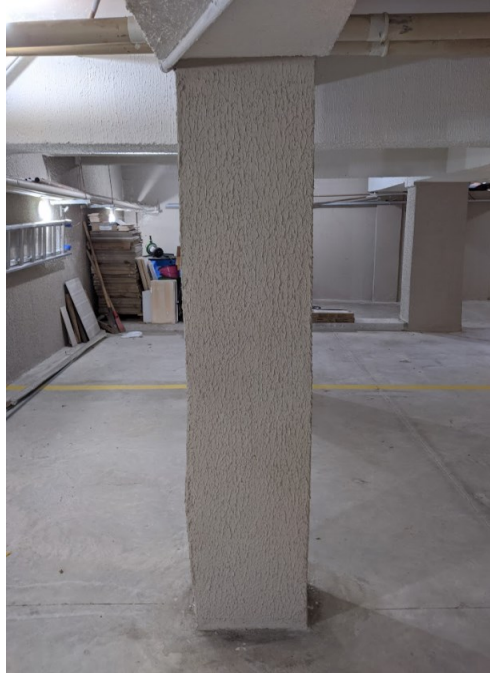
Figura 28 - Má execução no acabamento do pilar
