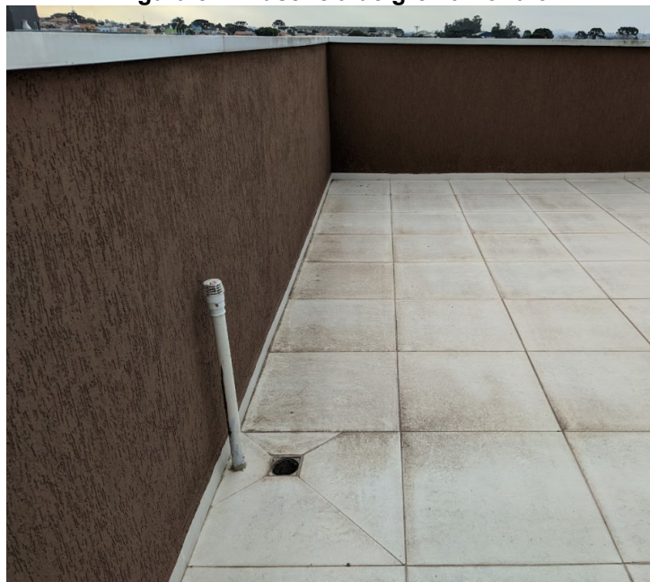
Figura 57 - Ausência de grelha no ralo
