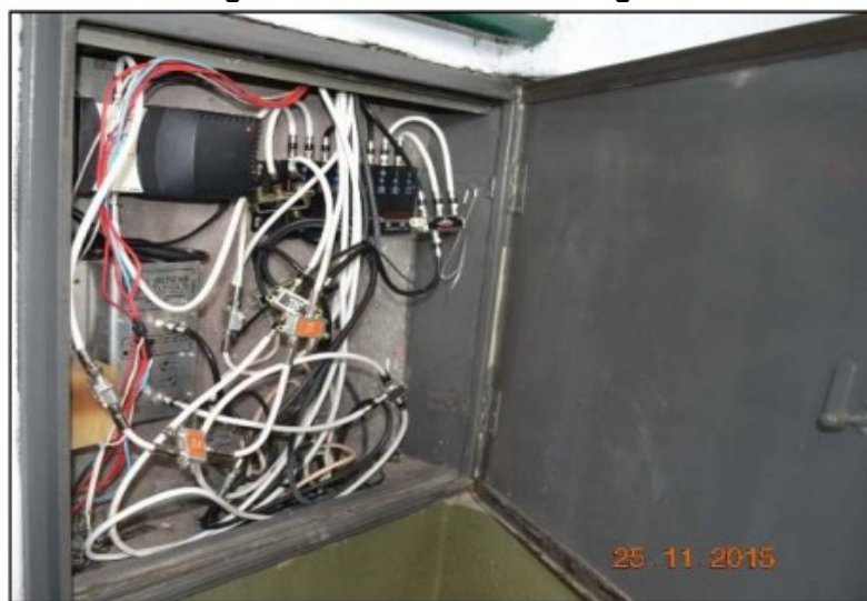
Figura 9 - Quadro elétrico irregular
