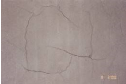
Figura 13 - Revestimento apresentando fissuração mapeada típica de retração da argamassa
