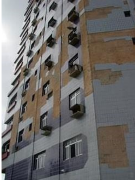
Figura 14 - Destacamento de revestimento cerâmico em fachada
