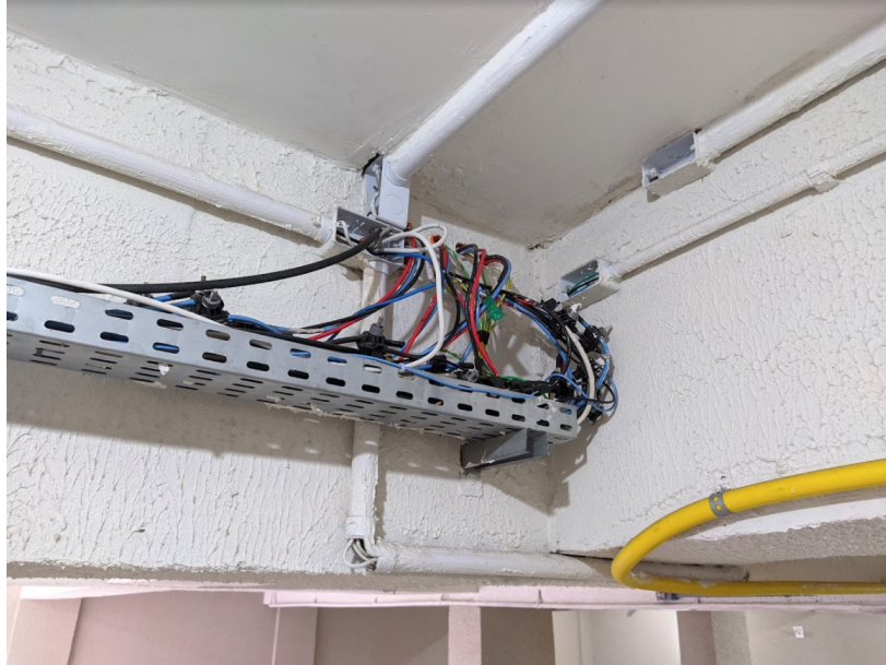
Figura 53 - Fiação exposta no estacionamento
