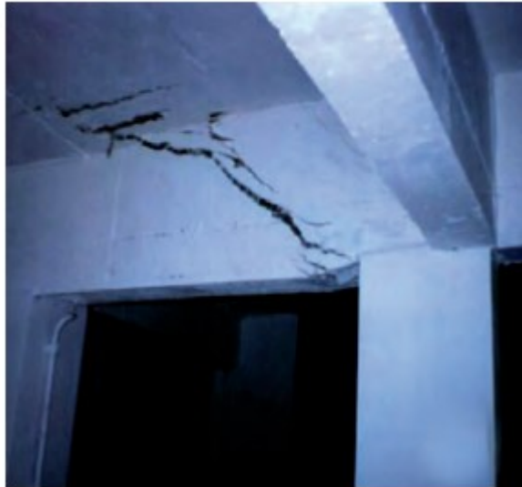
Figura 7 - Efeito de recalque diferencial em estrutura vizinha a grande escavação em perímetro urbano
