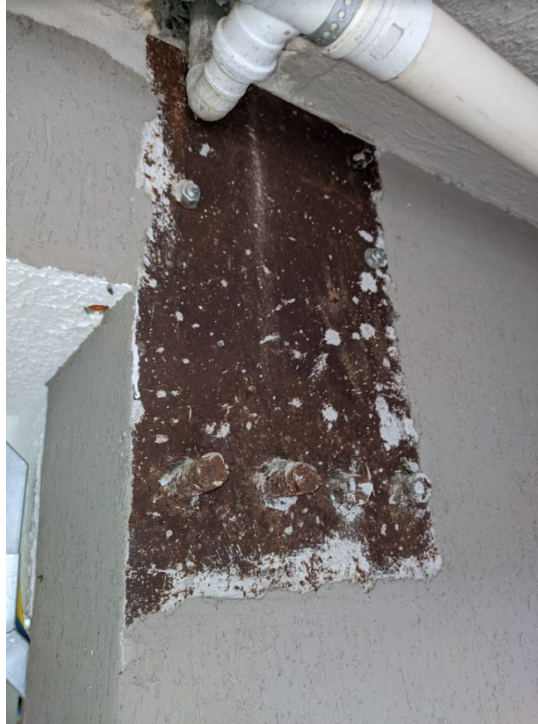
Figura 30 - Corrosão em um dos itens estruturais
