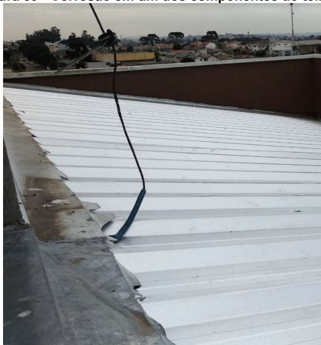
Figura 59 - Corrosão em um dos componentes do telhado
