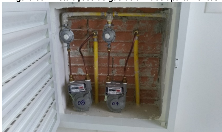
Figura 50 - Instalações de gás de um dos apartamentos
