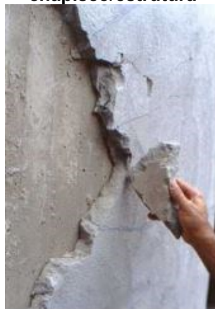
Figura 12 - Descolamento de placas grandes e coesas com ruptura na interface chapisco/estrutura
