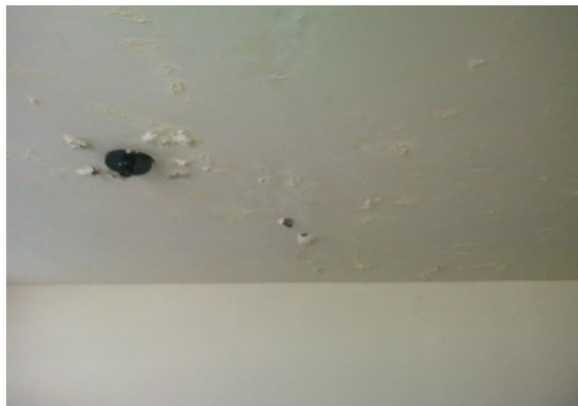
Figura 11 - Problemas em laje decorrente de infiltração
