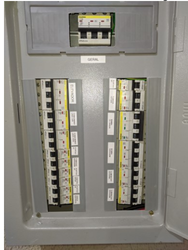
Figura 55 - Quadro de distribuição aberto
