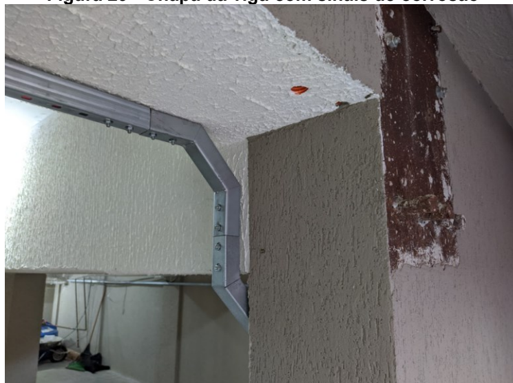
Figura 29 - Chapa da viga com sinais de corrosão
