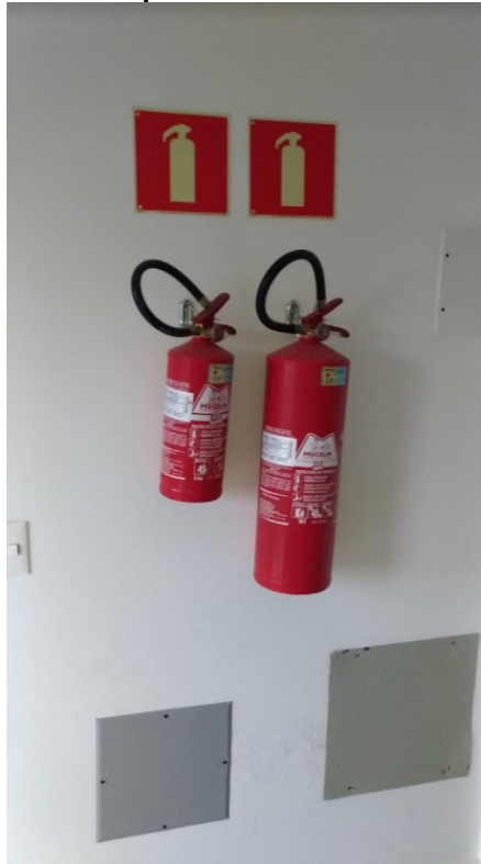
Figura 60 - Extintores presentes no hall entre apartamentos
