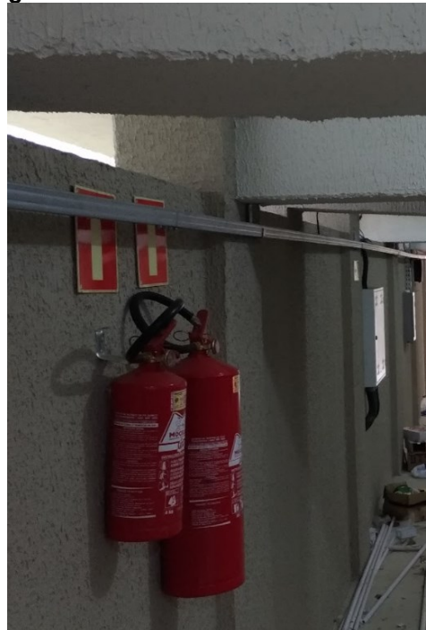
Figura 61 - Extintores no estacionamento
