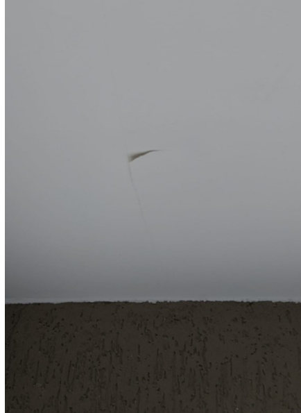
Figura 33 - Destacamento de forro
