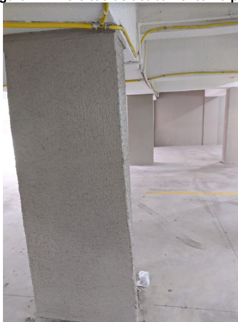
Figura 27 - Defeitos de acabamento no pilar
