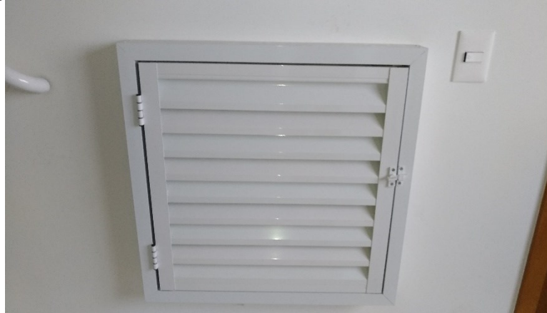
Figura 51 - Abrigo das instalações de gás de um dos apartamentos
