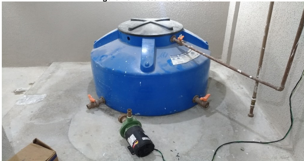
Figura 48 - Cisterna do edifício
