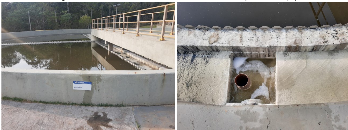
Figura 7 – Ponto de coleta do efluente tratado pela ETE (E).
