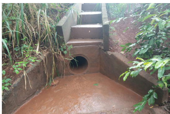
Emissário com plataforma em concreto
