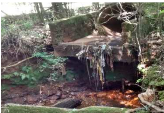
Estrutura de dissipação de energia colapsada
