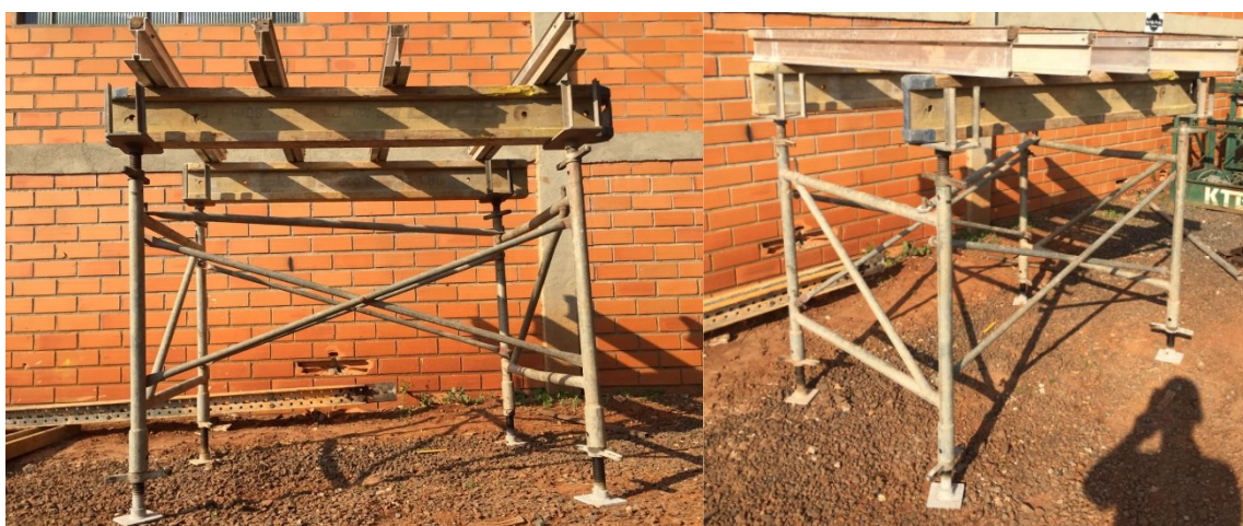
Figura 8 – Conjunto torre Metálica Fonte: Arquivo pessoal, 2020.
