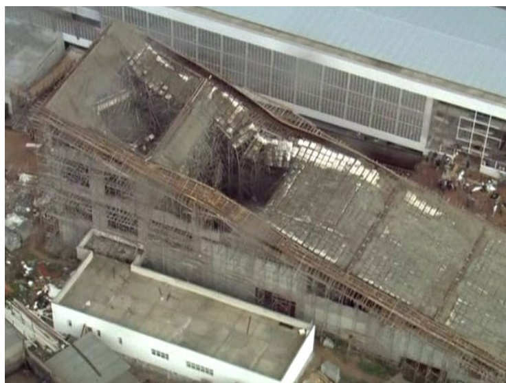
Figura 2 - Falha em escoramento de laje Fonte: Globo, 2020.
