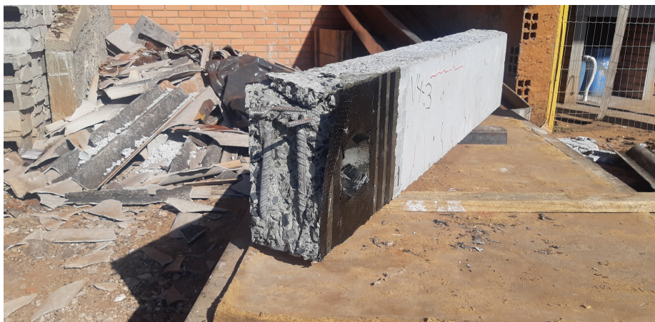
Figura 56 – Viga V4-3 rompida Fonte: Autoria Própria (2021).
